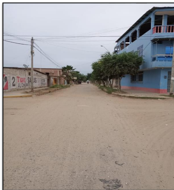
Verificación de pavimento en mal estado
