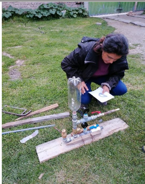
Imagen 3. Sistema de bomba de ariete instalado en forma horizontal.
