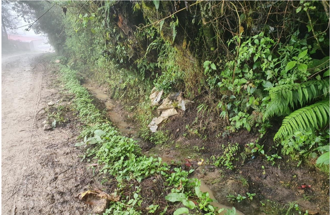
Figura 06: Vista escurrimiento de agua por cunetas inadecuadas de la vía.
