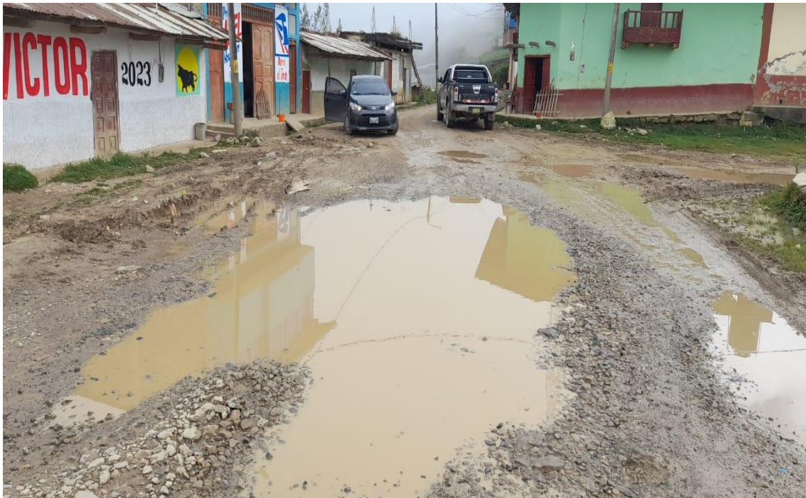
Figura 05: Vista de estancamiento de agua en la vía por no contar con obras de drenaje.
