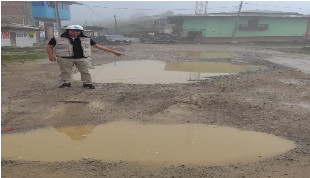
FIGURA 01: Vista de empozamiento de agua en la vía.
