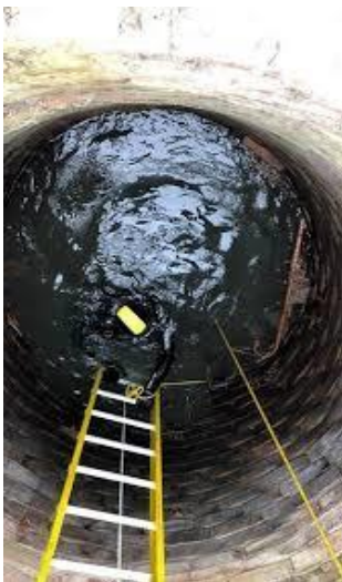
Figura 9. Foto Pozo séptico
