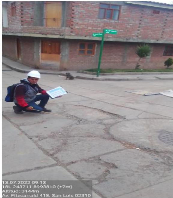
Figura 13. Vista de punzonamiento
