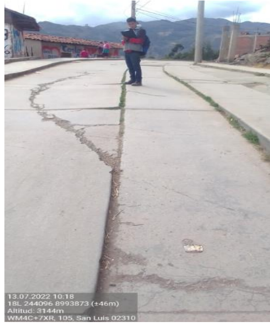
Figura 10. Vista de grietas de esquinas
