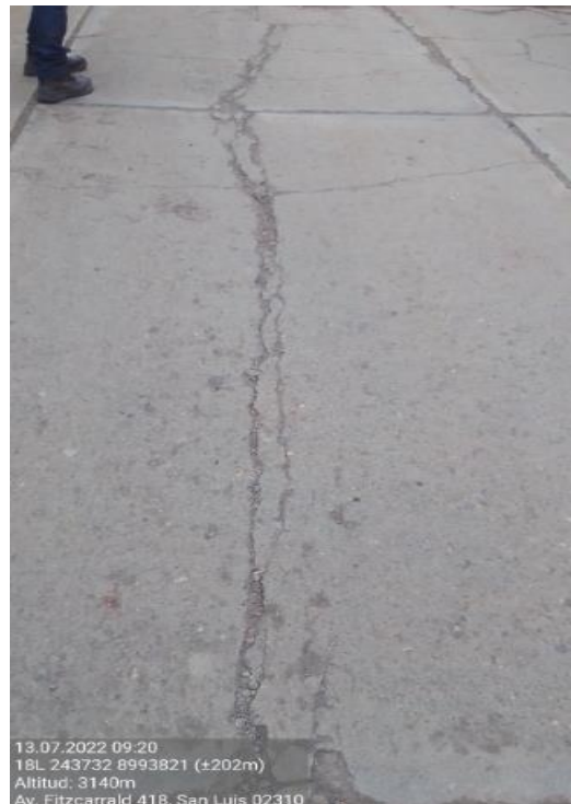
Figura 4. Vista de grietas lineales
