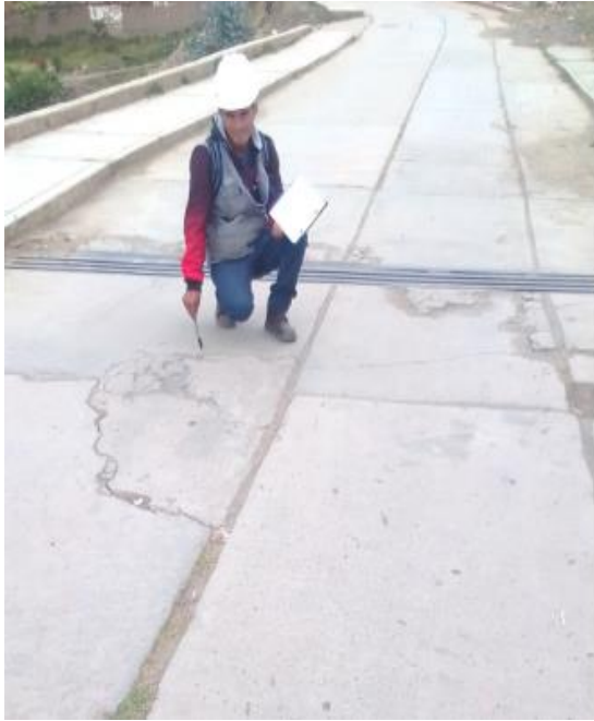
Figura 9. Vista de grietas de esquinas
