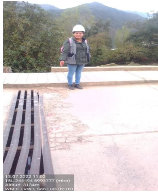
Figura 14. Vista de punzonamiento
