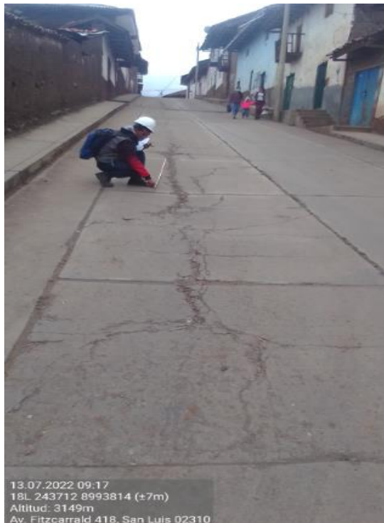
Figura 3. Vista de grietas lineales
