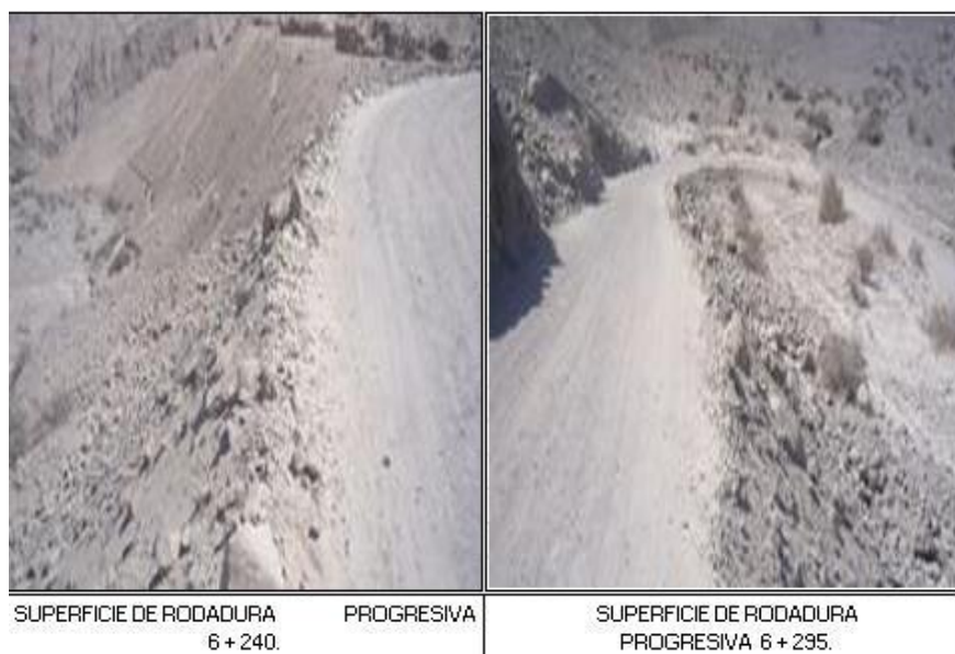
Figura N° 7. Curvas cerradas sin presencia de guardavías
