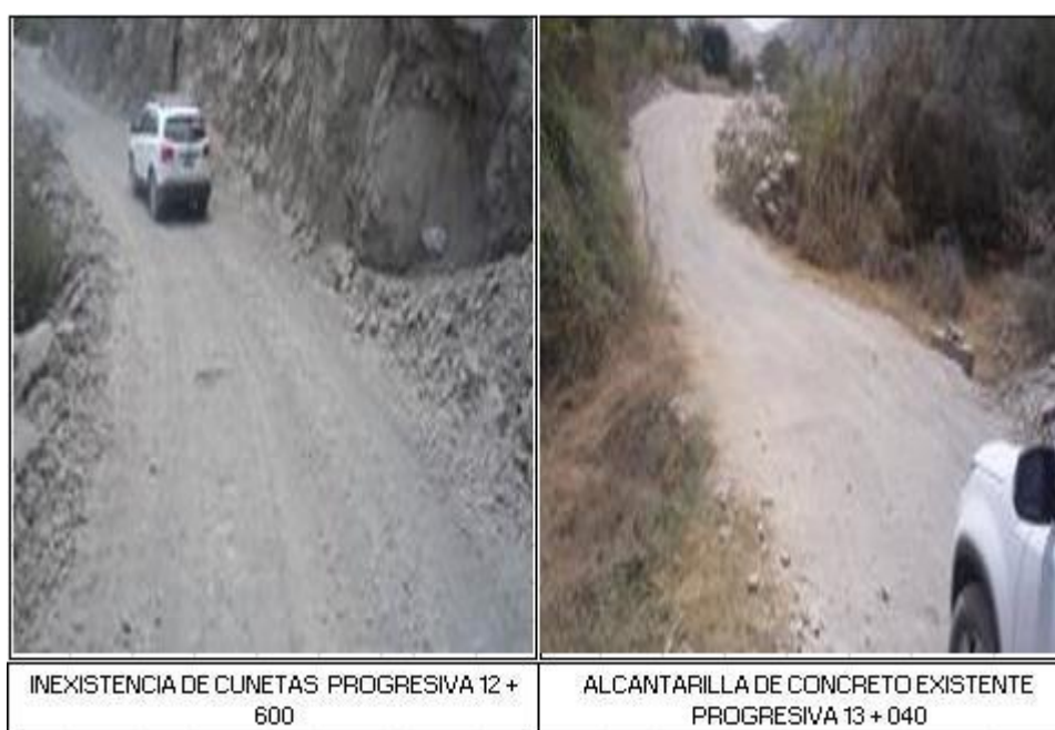
Figura N° 9. Vista de alcantarillas y ausencia de cuentas
