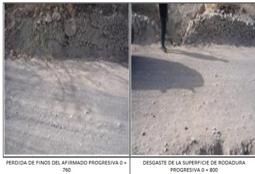
Figura N° 6. Superficie de rodadura desgastada y encalaminado
