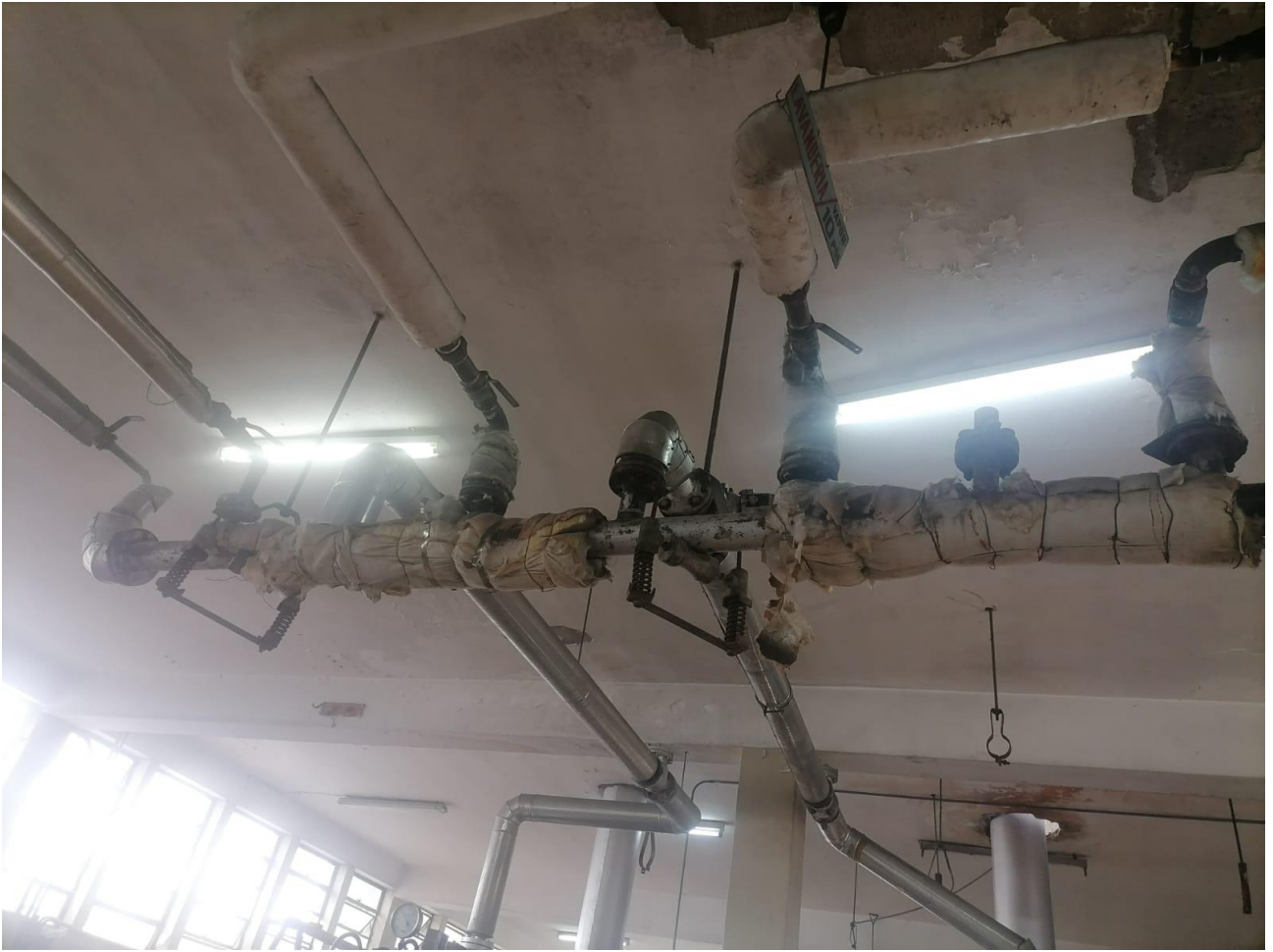
Lugar donde se distribuye el vapor a las Áreas que las necesitan.
