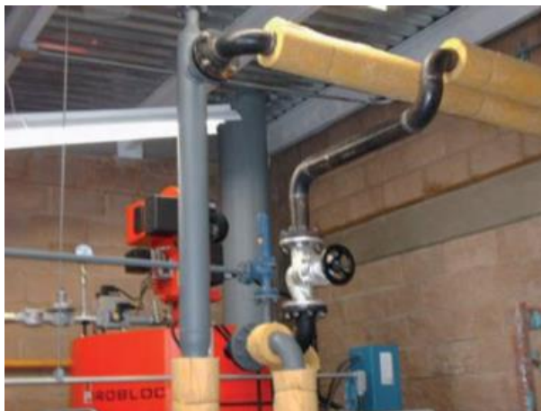
Figura 2: Aislamiento térmico en redes de vapor y condensado
