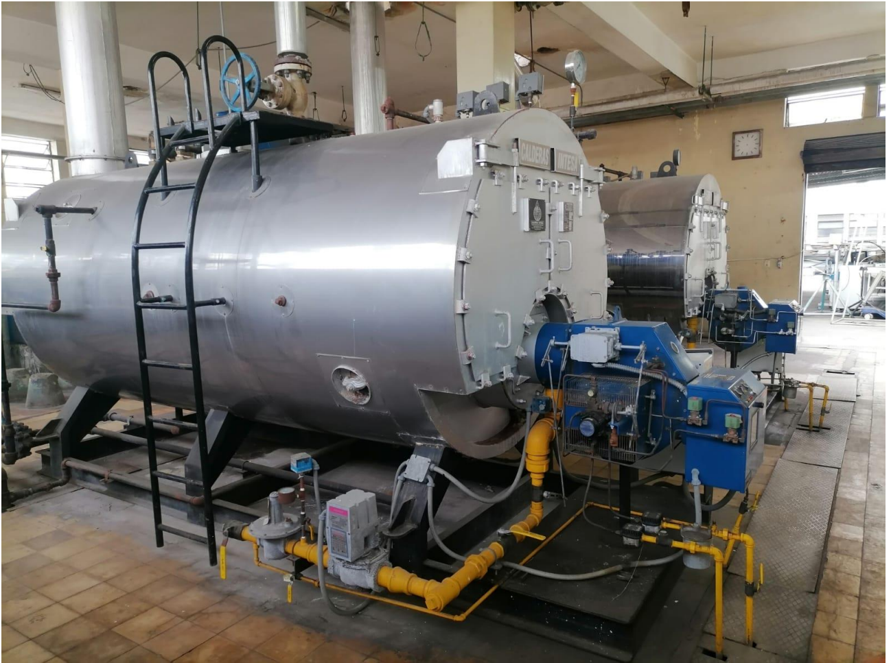
Las calderas pirotubular de 100 BHP
