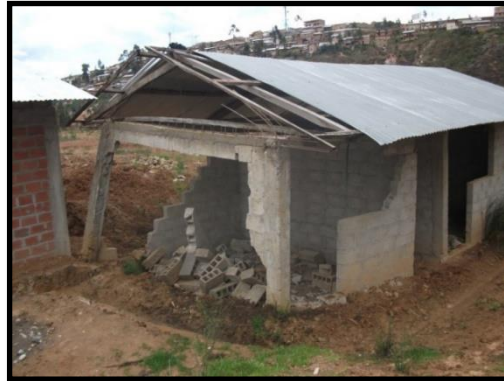
Imagen N° 2: Desplomo de vivienda en la ciudad de Chachapoyas causado por sismo ocurrido en Noviembre del 2021
