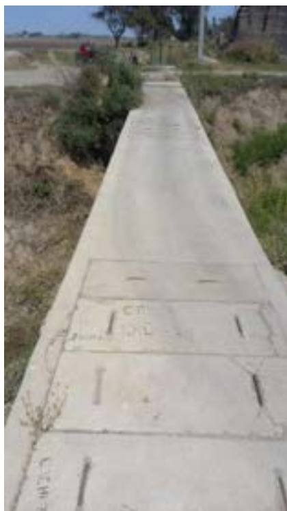
Imagen 33: Alcantarilla de riego agrícola que ha quedado en desuso.
