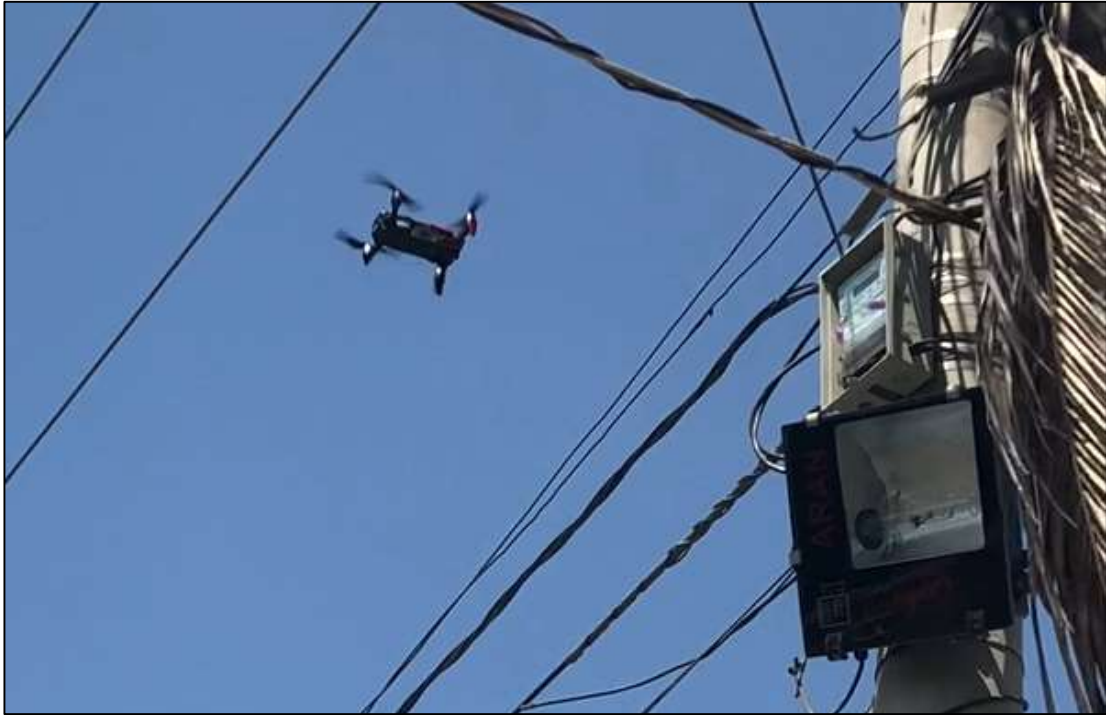
Figura 04. Existencia de varios cableados en registro Fuente: Elaboración propia
