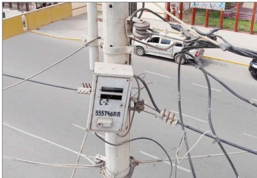
Figura 13. Medidor con protección
