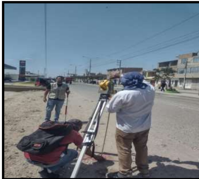
Foto n° 02.-Vista fotográfica de la colocación de BMs 04, en la avenida agricultura km o+540.00
