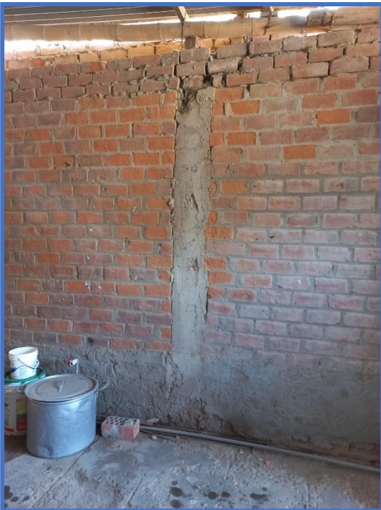
Fisuras en las columnas
