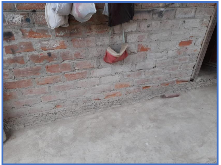
Deterioro en los muros
