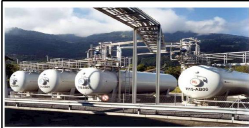
Figura 29. Tanques de baja Presión
