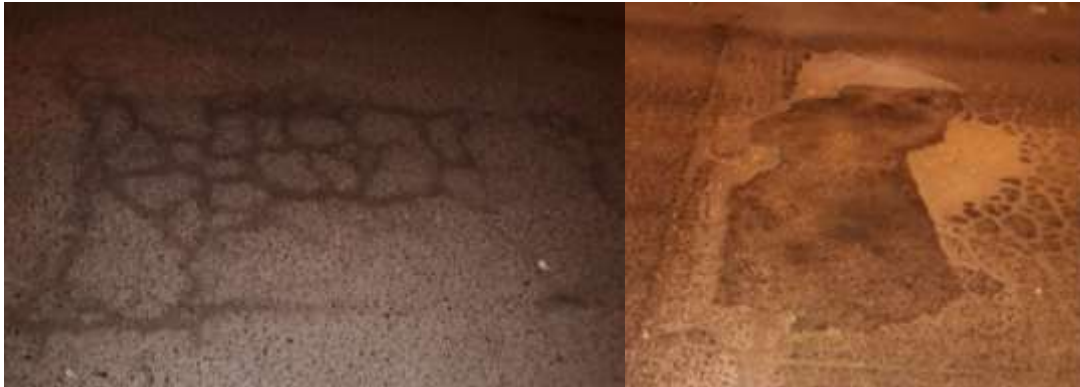
Grieta Piel de Cocodrilo (Fuente: Elaboración Propia)
