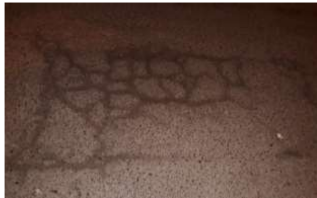
Figura 09: Evaluación de la falla piel de cocodrilo.
