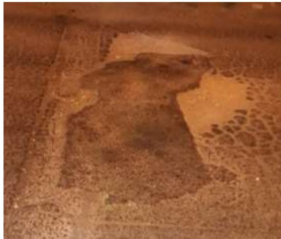
Figura 10: Evaluación de falla Parcheo.
