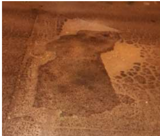
Figura 14: Evaluación de falla Parcheo.
