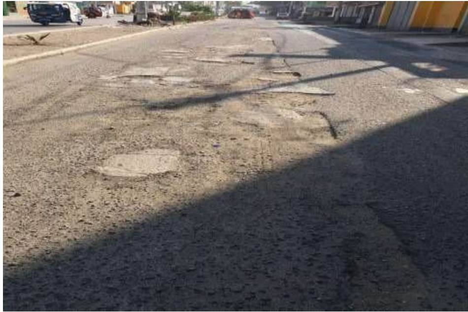
Figura 01: Fallas de fisuras longitudinales y transversales en pavimentos.
