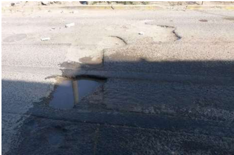
Figura 02: Fallas de piel de cocodrilo en los pavimentos.
