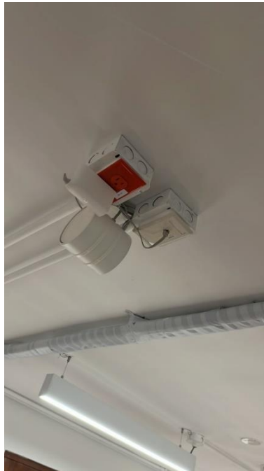
Figura 10-Conexión de Nodo principal del piso
