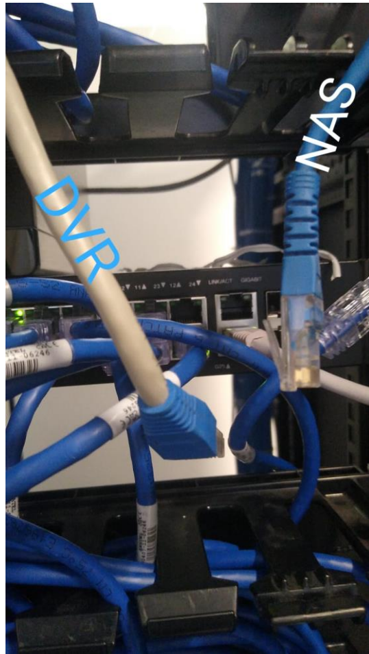
Figura 13 - Etiquetado de cables y reserva de puertos
