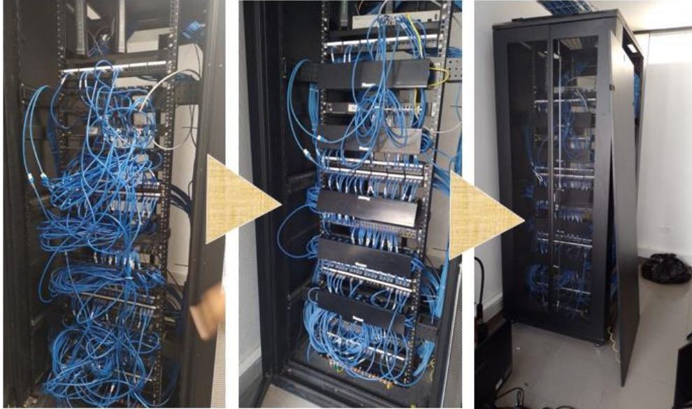
Figura 9- Implementación del Rack de Comunicaciones
