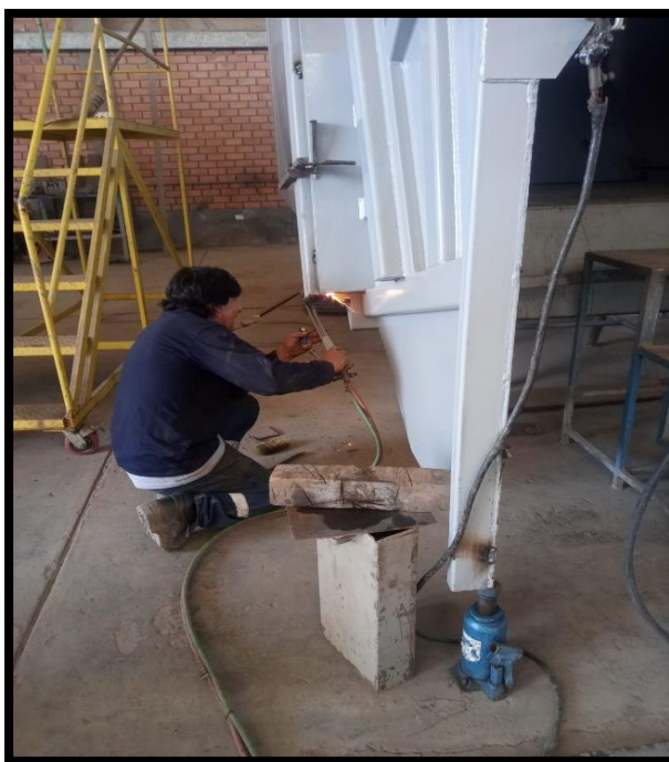
Figura 20: Equipo de EPP incompleto
