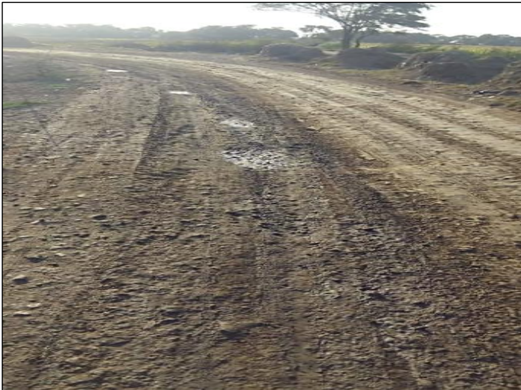
Figura 1: Situación actual de la trocha Los Peches – Paredones
