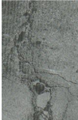
Figura 10. Grietas longitudinales y transversales de alta severidad
