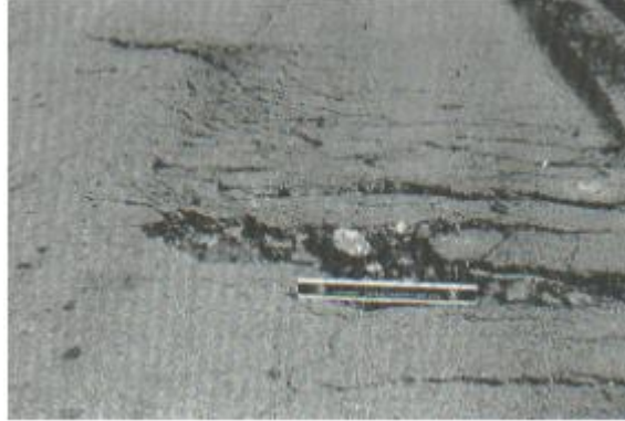
Figura 17. Grietas parabólicas de alta severidad
