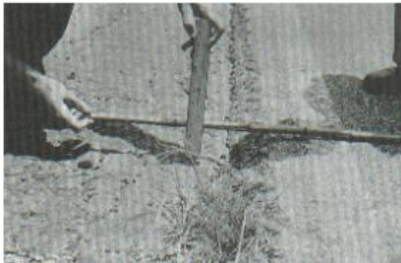
Figura 9. Desnivel carril/berma de severidad media
