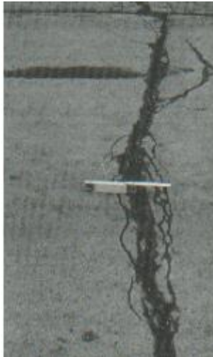
Figura 8. Grieta de reflexión de junta de alta severidad
