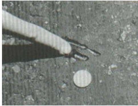
Figura 2. Exudación de severidad media
