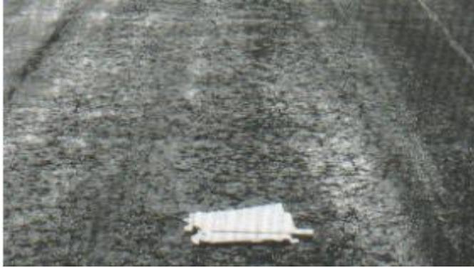
Figura 19: Desprendimiento de agregados de severidad media
