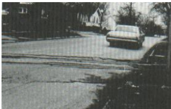
Figura 14. Cruce de vía férrea de severidad alta
