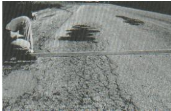
Figura 1. Piel de cocodrilo de alta severidad
