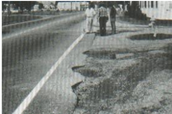
Figura 7. Grieta de borde de alta severidad
