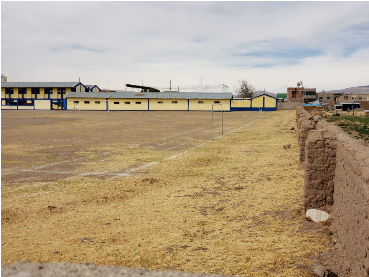
Figura 3: El estado actual del cerco perimétrico
