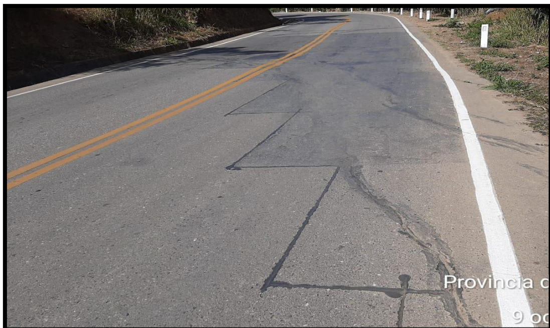
Figura 02. HUNDIMIENTOS EN EL PAVIMENTO FLEXIBLE (MUESTRA 2)
