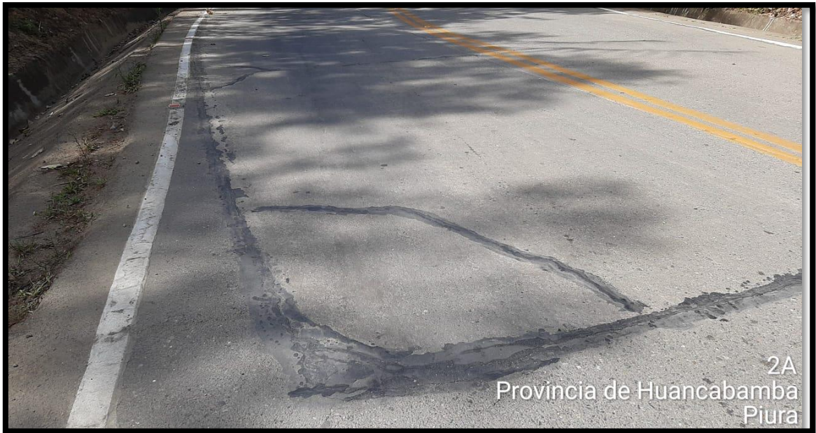
Figura 03. HUNDIMIENTOS EN EL PAVIMENTO FLEXIBLE
