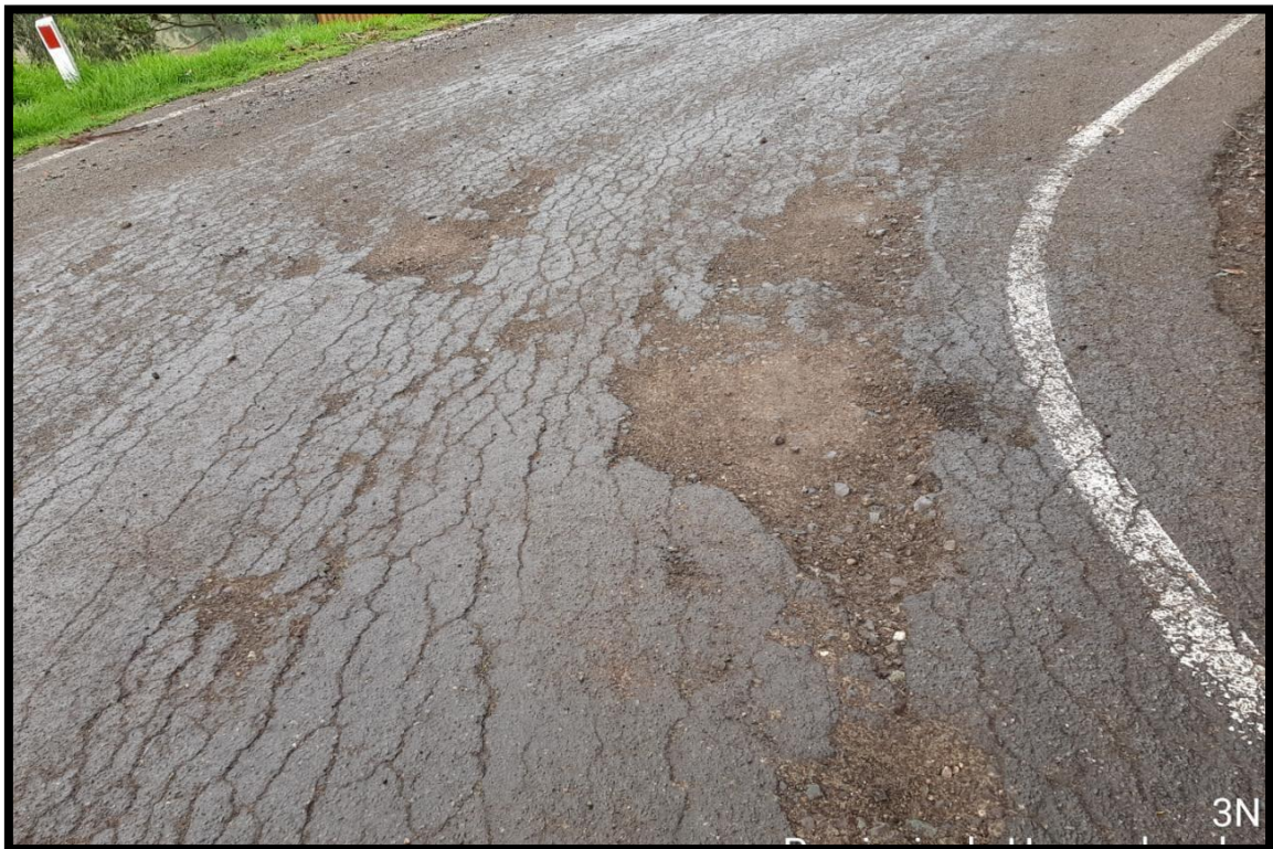
Figura 04. PATOLOGIAS S EN EL PAVIMENTO FLEXIBLE
