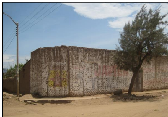
Ilustración 49: Contaminación visual provocado por el deterioro de las viviendas Fotografía tomada por autores
