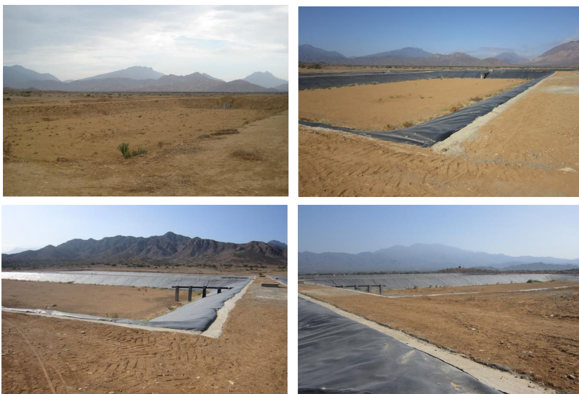
Ilustración 40: Vistas de la Laguna de Oxidación
