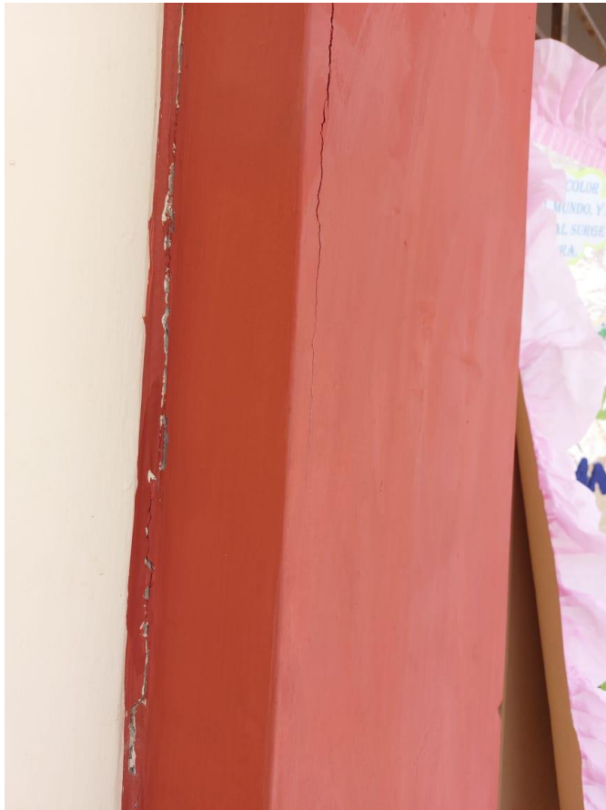
Grieta vertical en la columna.
