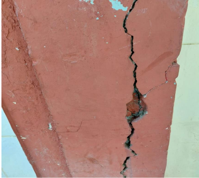
Agrietamiento de las columnas.
