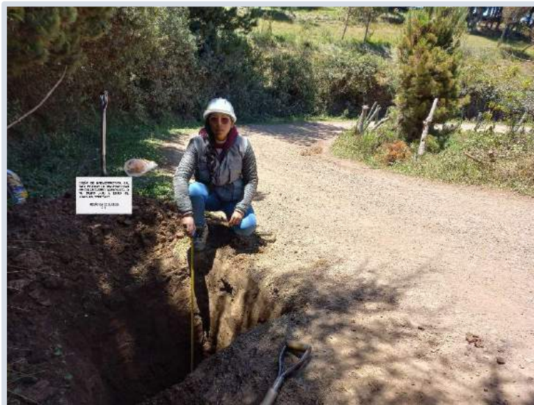
Figura 80. Estudio de mecánica de suelos del Diseño de infraestructura vial para mejorar la transitabilidad vehicular centros poblados Uyurpampa – Marayhuaca (0+000Km - 9+862Km) C18, setiembre 2022.
