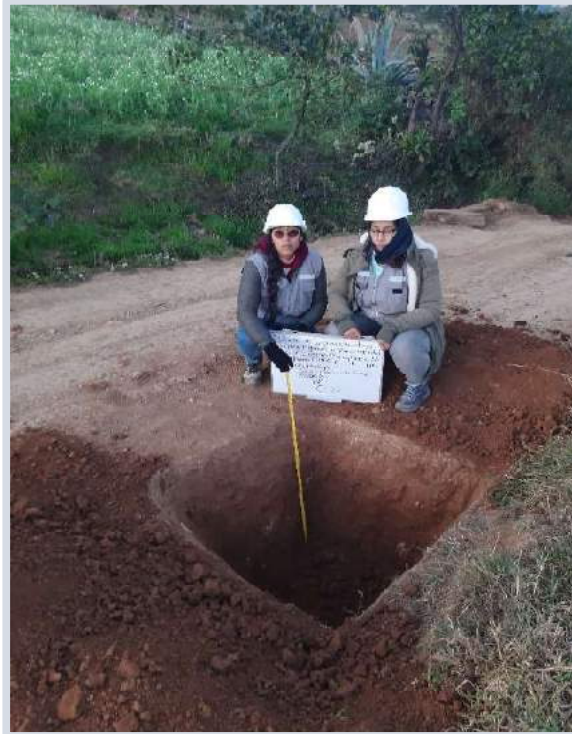
Figura 67. Estudio de mecánica de suelos del Diseño de infraestructura vial para mejorar la transitabilidad vehicular centros poblados Uyurpampa – Marayhuaca (0+000Km - 9+862Km) C5, setiembre 2022.
