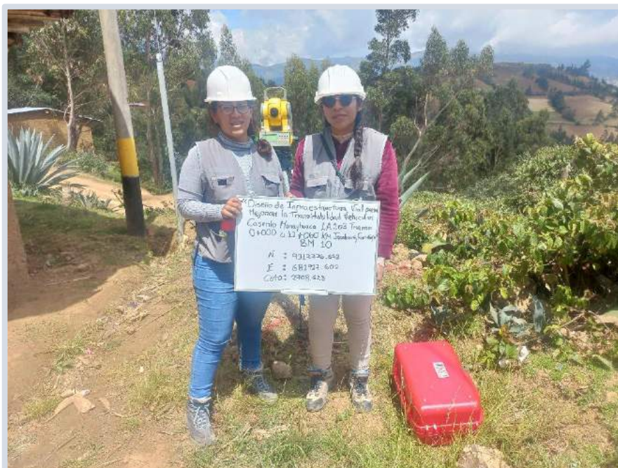
Figura 2. Levantamiento topográfico del Diseño de infraestructura vial para mejorar la transitabilidad vehicular centros poblados Uyurpampa – Marayhuaca (0+000Km - 9+862Km), Incahuasi - Ferreñafe, 2022, BM 10, setiembre 2022.
