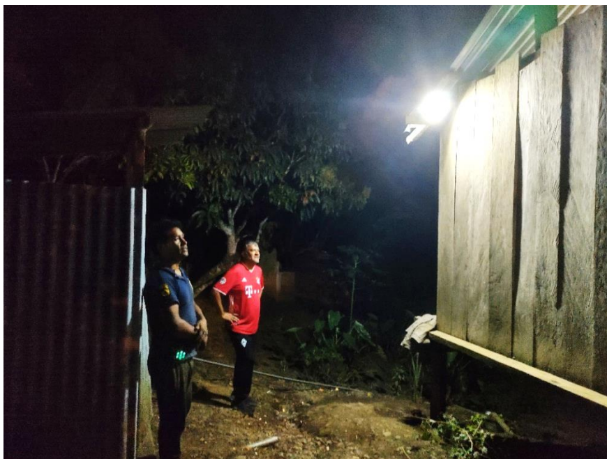
Figuras 39 y 40.- Instalación de luces genéricas con sensor de movimiento
