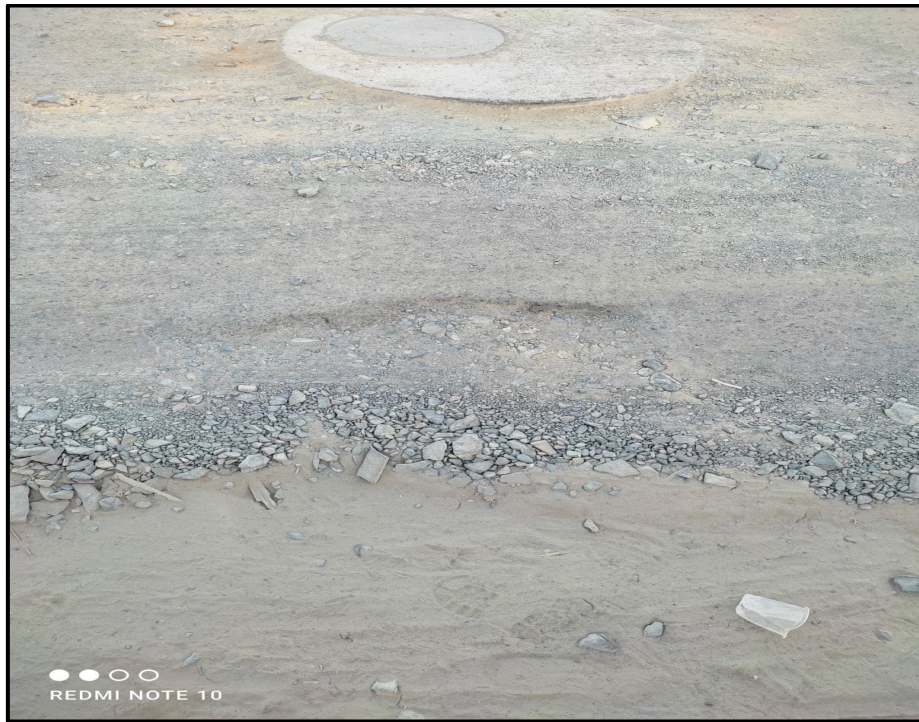
Figura 17 - Observación y calificación de falla tipo bacheo y parcheo con fisura de borde.
