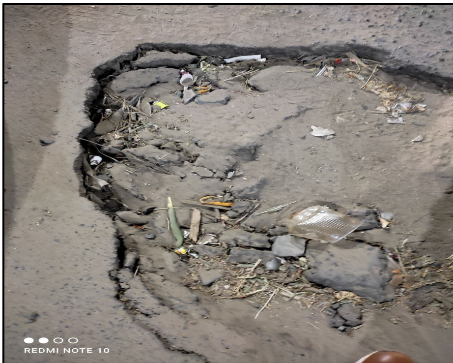
Figura 18 - Huecos o baches en el pavimento flexible del tramo k 0+200.
