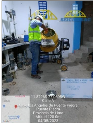
Figura 38. Vertimiento del cemento (2 % de vidrio)
