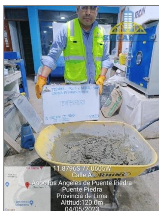
Figura 41. Temperatura del concreto - NTP 339.184/ASTM C1064 (2 % de vidrio)
