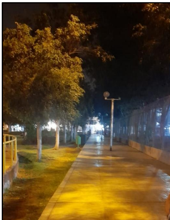
Figura 13. Vista de las áreas oscuras en la plaza y con las iluminarias que no funcionan.
