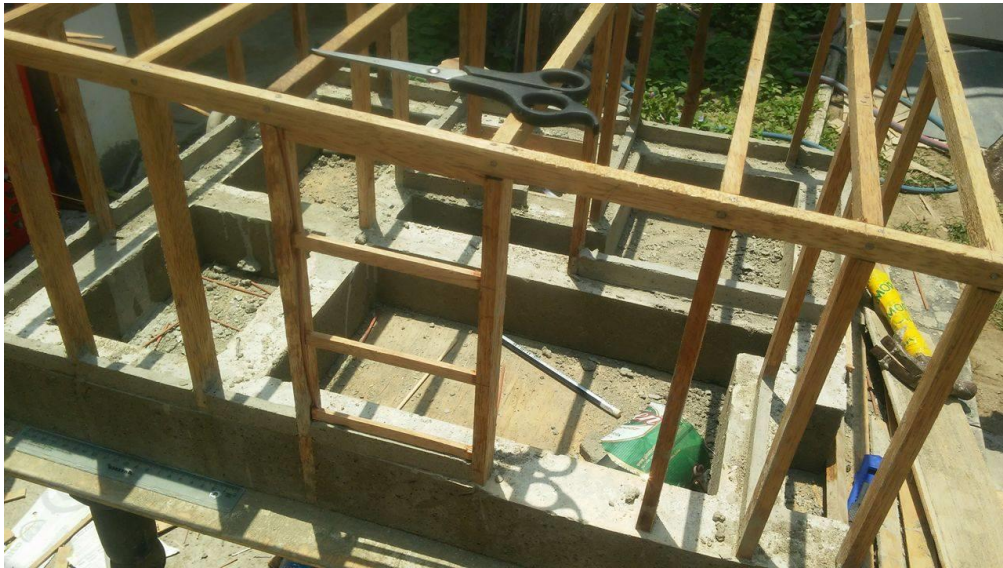
Figura N°12 Se desencofro y sobrecimiento y se procedió a colocar los travesaños entre caras interiores de columnas
