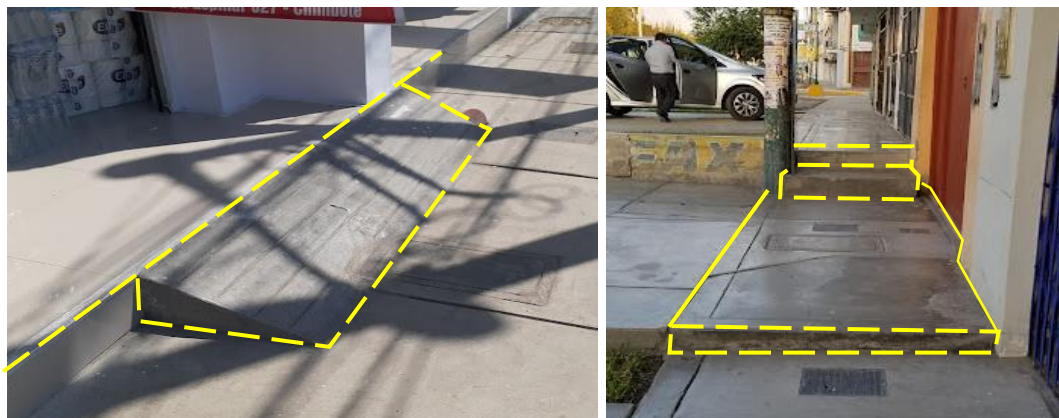
Figura 30. Rampa que interrumpe el espacio público para dar acceso a la edificación privada y escalones en la vereda sin rampas que limitan la transitabilidad de algunas personas.
