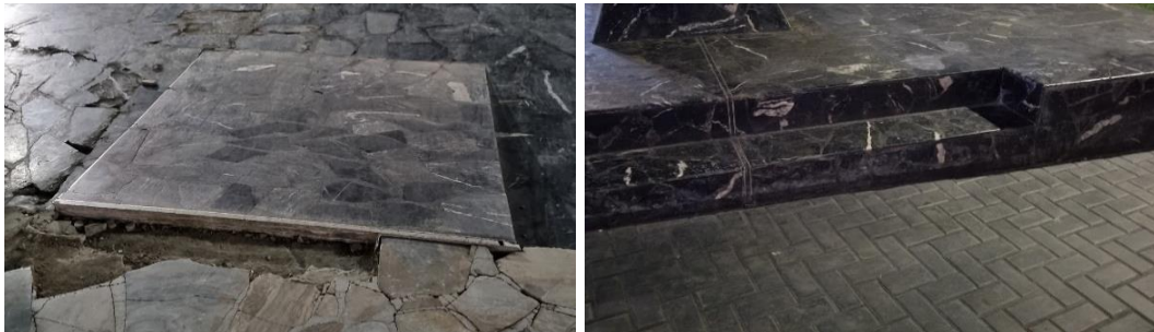
Figura 9. Rampa deteriorada y dañada, y los escalones del pabellón en regular estado. Fuente: Foto propia tomada en abril del 2023.
