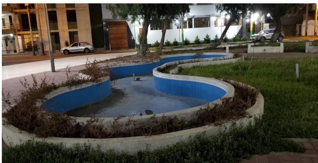
Figura 16. Fuente de agua inactiva y descuidada.
