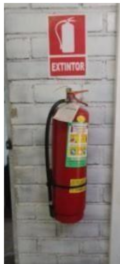
Figura 23: Señalización de la agrupación Aquatermica.
