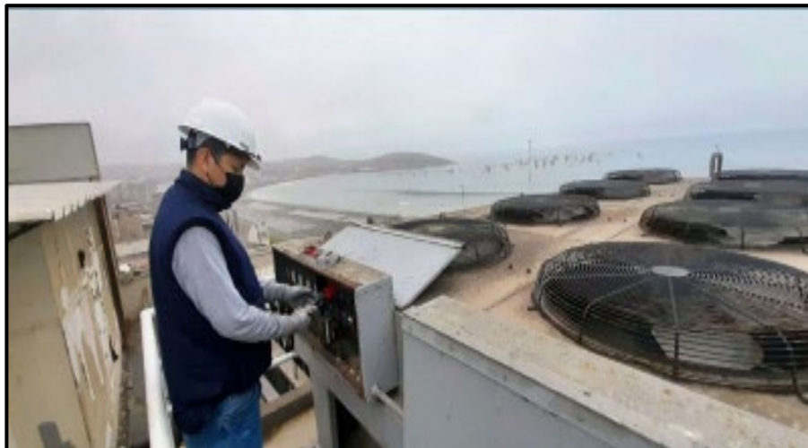
Figura 3. Mantenimiento del PLC de sistema de refrigeración Origen: Brochure de la organización
