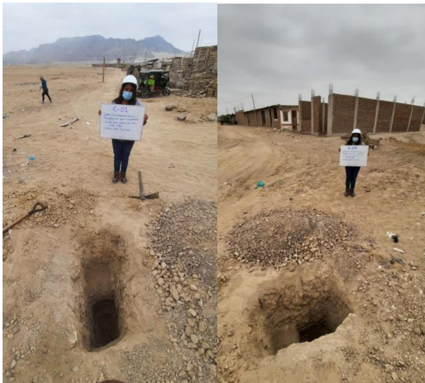
Figura 2. Estado del pavimento
