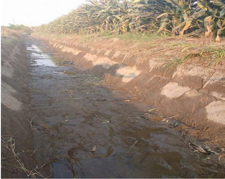
Foto N° 09: Vista del Canal revestido completamente desgastado y de sección trapezoidal.
