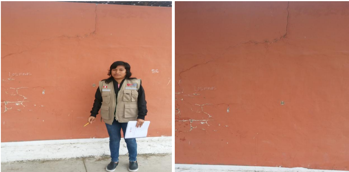
Gráfico N° 02 y 03: Vivienda resanada anteriormente por fisuras que aparecieron nuevamente.
