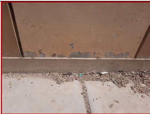
Visualización del desprendimiento de la pintura en la parte inferior de la estructura por posible presencia de salitre
