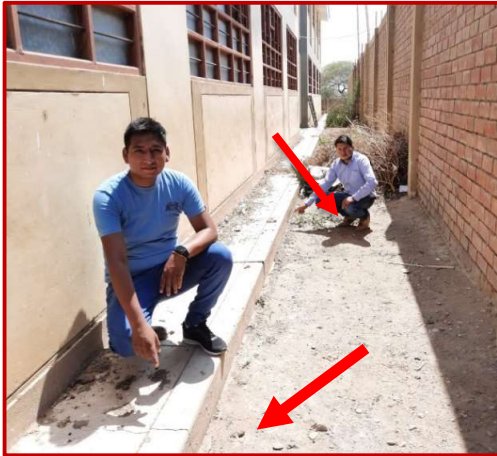
Visualización de grietas existentes en la vereda de circulación exterior, en la parte posterior del pabellón en estudio.
