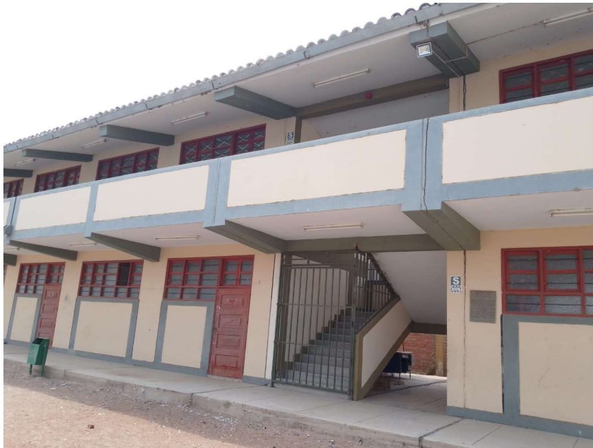
Figura 5 Vista del módulo “01” el cual es de material noble, el cual presenta fisuras y grietas en diferentes zonas y puntos críticos de la estructura.
