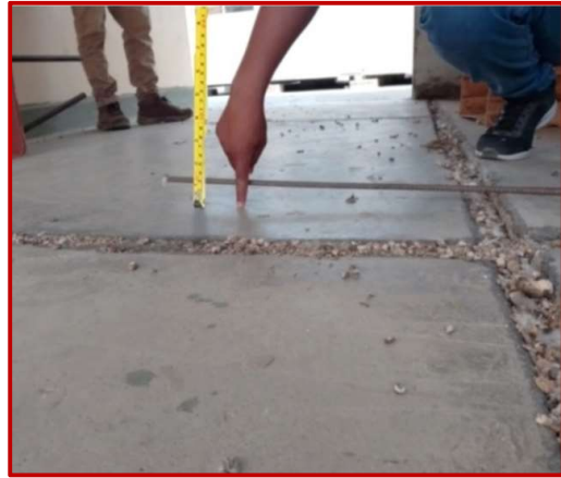
Visualización de los desniveles existentes entre los paños que conforman la vereda del pabellón en estudio.
