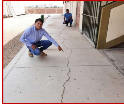
Visualización de grietas existentes en la vereda de circulación exterior frontal del pabellón en estudio.
