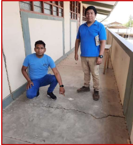
Visualización de grieta en piso superior, por falta de junta de dilatación.
