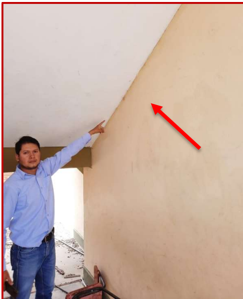
Visualización de fisuramiento en la garganta de la escalera con el muro
