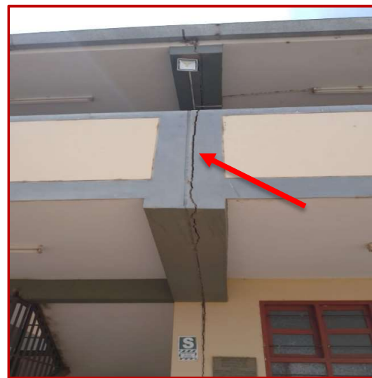
Visualización de falla de junta de dilatación en ambos niveles.
