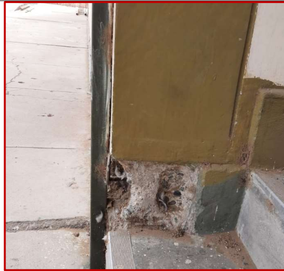
Visualización de un mal procedimiento en la instalación de las rejas metálicas de la escalera. Dejando expuesto el acero de la columna.
