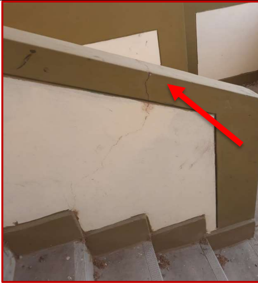
Visualización de fisura en tabiquería de escalera.
