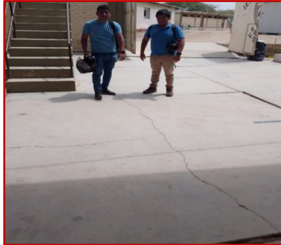
Visualización de fisura en la Losa deportiva, se evidencia abundantes fisuras en los paños de la losa deportiva
