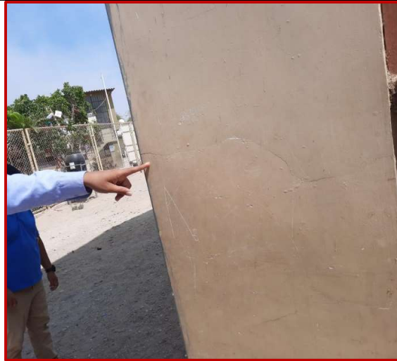
Visualización de encajonamiento del recubrimiento de la columna.
