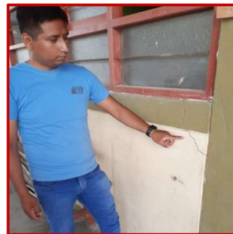
Visualización de fisura en tabiquería.
