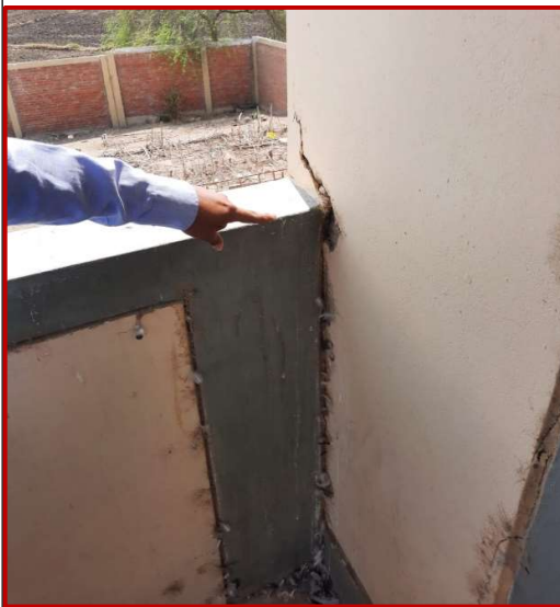
Visualización de grieta en recubrimiento de columna por daños de dilatación.
