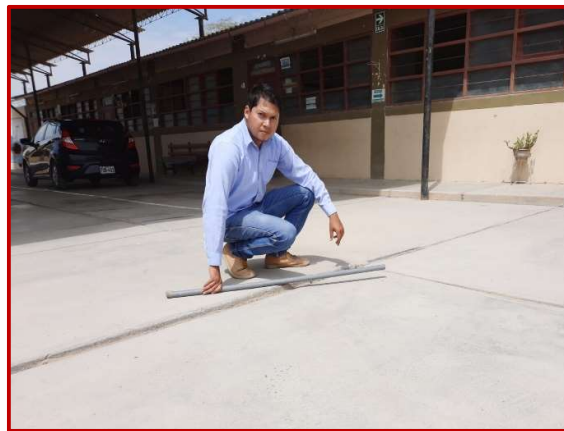
Desnivel en los paños de la losa deportiva principal de la I.E.
