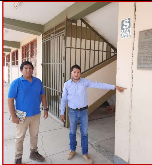
Inspección y/o visualización ocular de la estructura de la I.E. investigadores en compañía del ingeniero asesor de peritaje.
