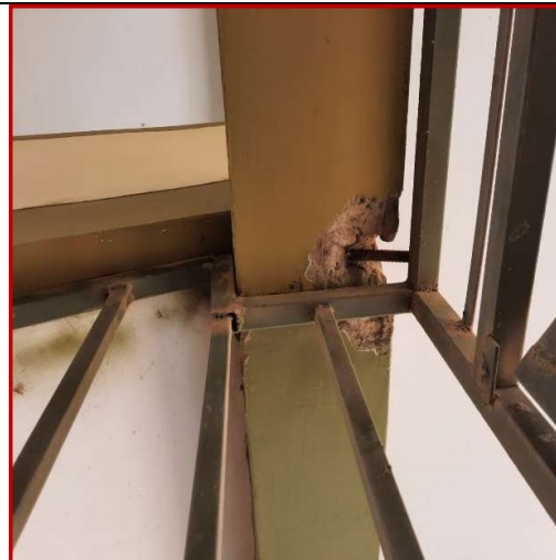
Visualización de rotura de viga, para instalación de reja metálica debilitando dicho elemento estructural y dejando expuesto el acero de la viga.
