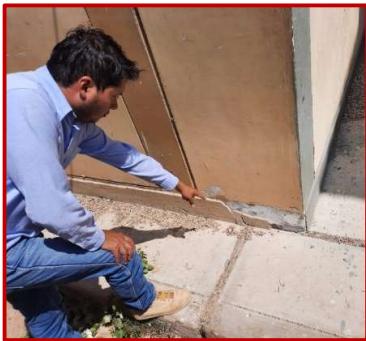
Visualización de desprendimiento del sócalo en la parte exterior del pabellón en estudio.
