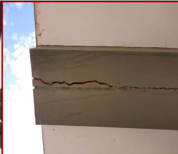
Falla del funcionamiento de la junta de dilatación, perjudicando las vigas estructuralmente.
