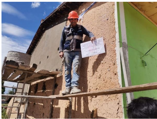
Foto 09: Enmallado y tarrajeo de muro de adobe; con la finalidad de evitar las patologías del adobe.
