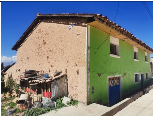
Foto 05: Muro de adobe de la vivienda del sr. Edgar Pablo Bastidas Alvarado.
