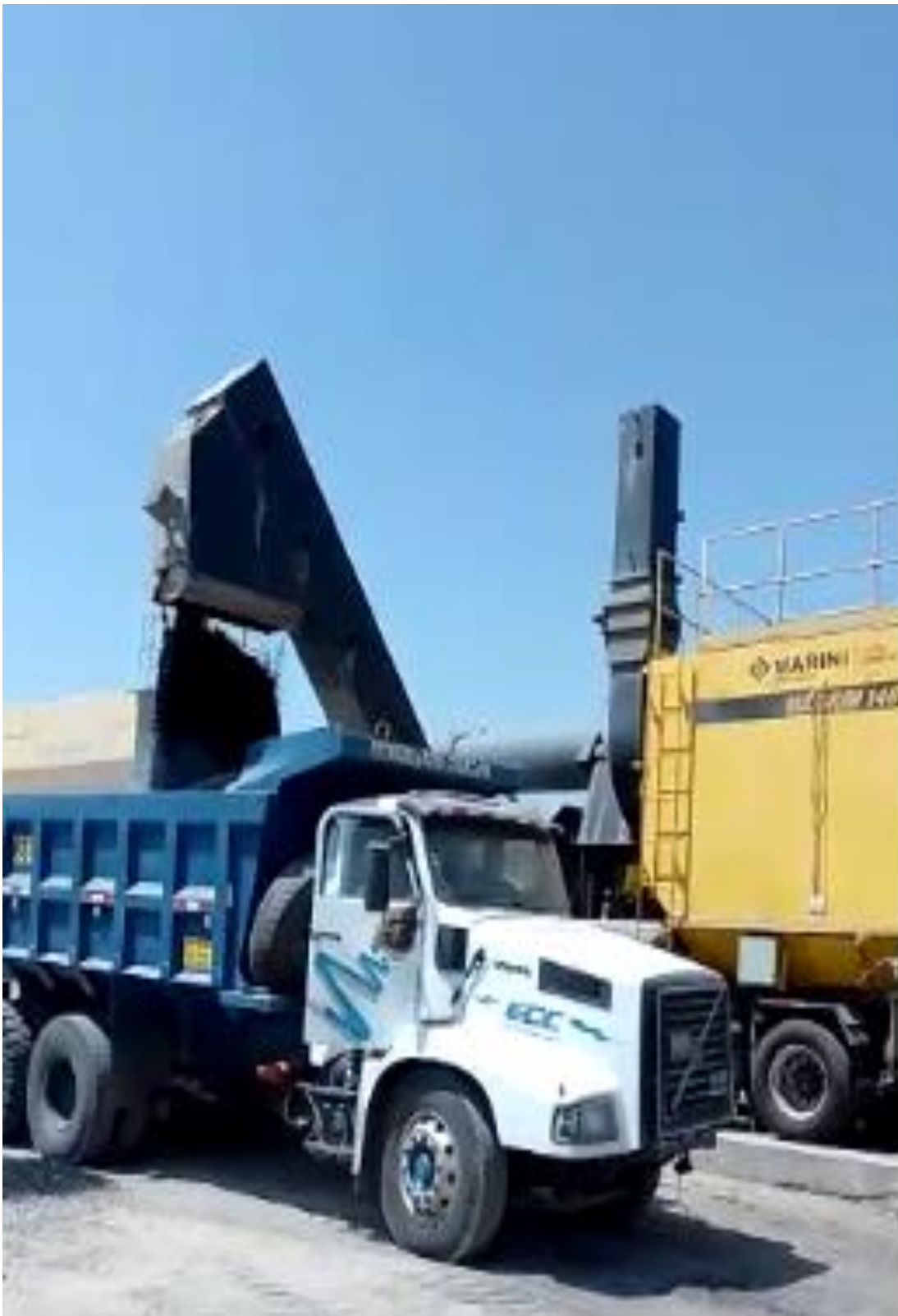
Figura 10. Planta de asfalto Marini con filtro de mangas
