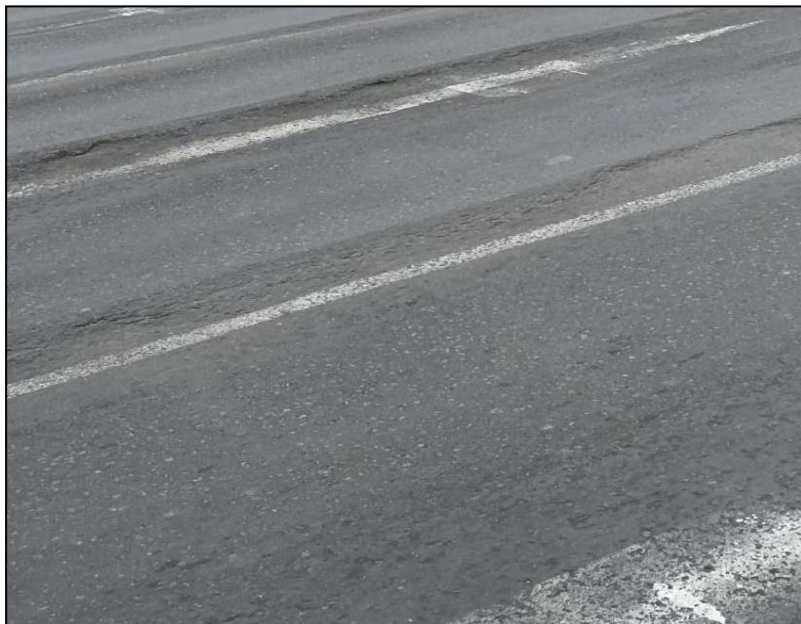
Figura 31, Ahuellamiento de carpeta asfáltica, Fuente: Propia.
