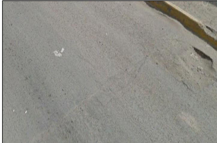
Figura 28, Fisura con desprendimiento, Fuente: Propia.
