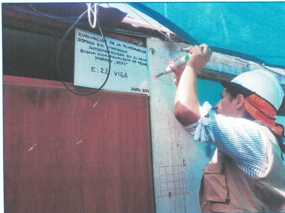
Imagen 26: Ensayo de Esclerometria en vivienda Mz O– Lt 02-AA.HH. Buena Villa, Huarmey.
