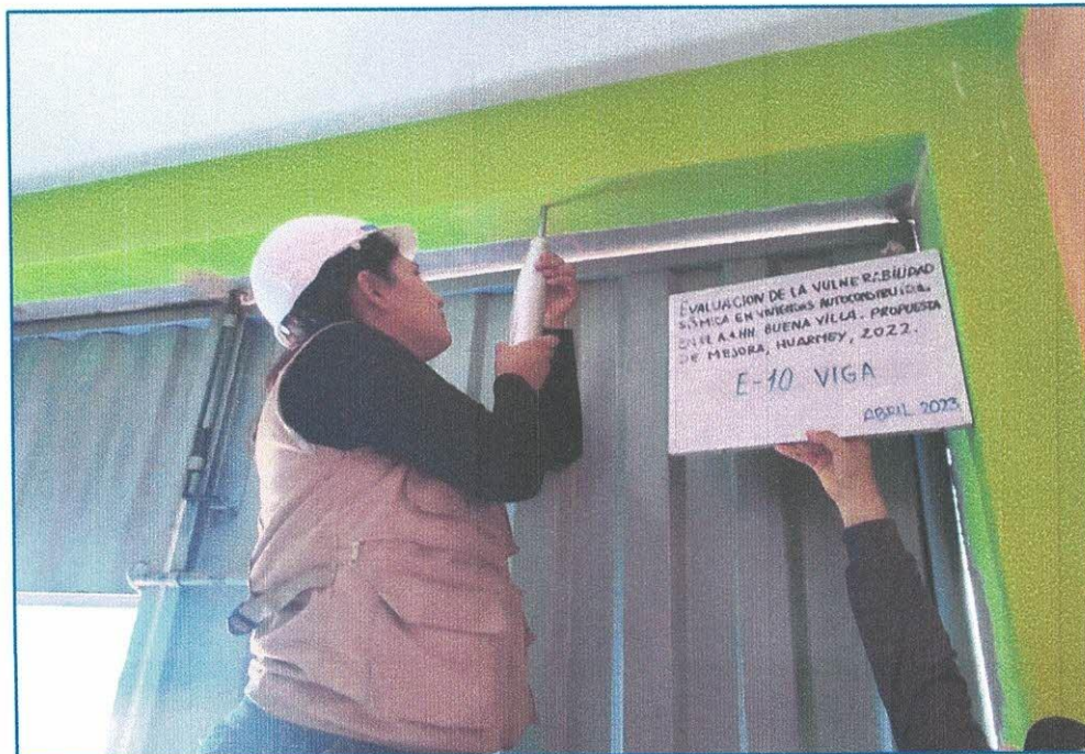
Imagen 14: Ensayo de Esclerometria en vivienda Mz L- Lt 11-AA.HH. Buena Villa, Huarmey.
