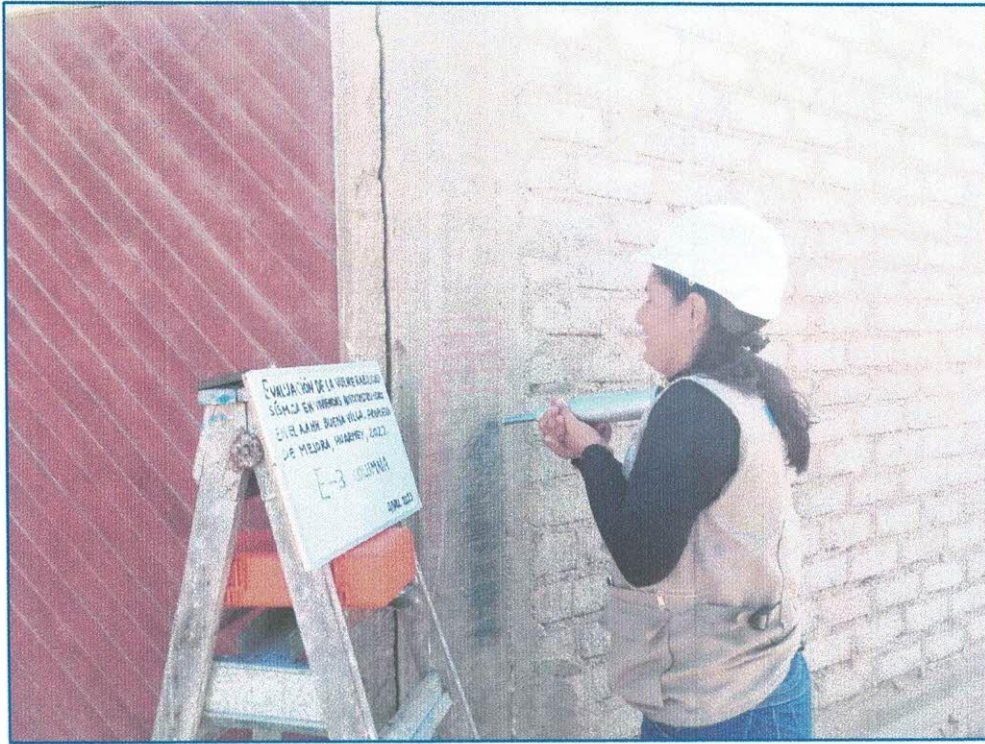
Imagen 07: Ensayo de Esclerometria en vivienda Mz Q– Lt 08 -AA.HH. Buena Villa, Huarmey.
