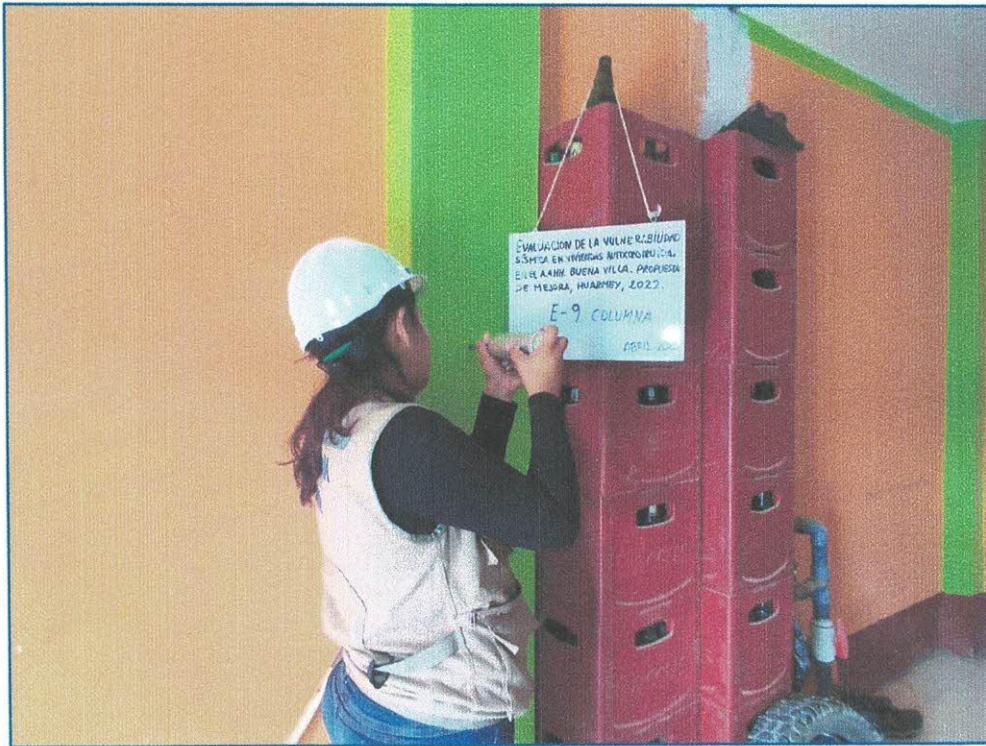
Imagen 13: Ensayo de Esclerometria en vivienda Mz L- Lt 11-AA.HH. Buena Villa, Huarmey.
