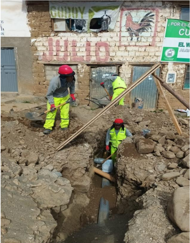
Fotografía 06: Ausencia de señalización de seguridad
