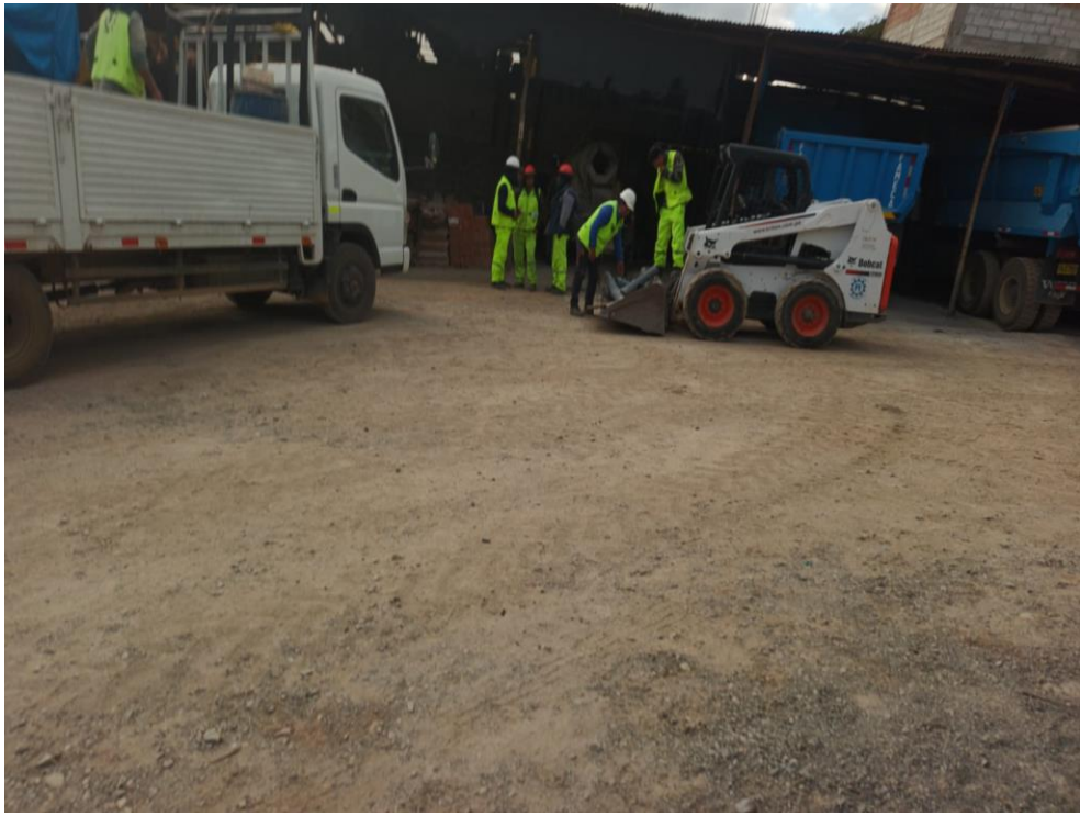
Fotografía 05: Ausencia de señalización de seguridad
