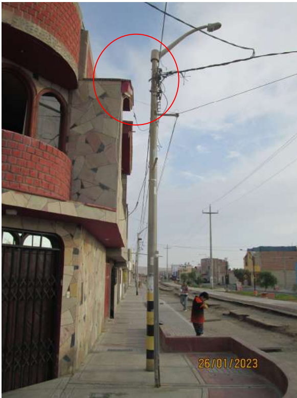
FIGURA A-9 LUGAR: SED D-1447/1-09 OBSERVACIONES: Conductor incumple DMS horizontal a edificación
