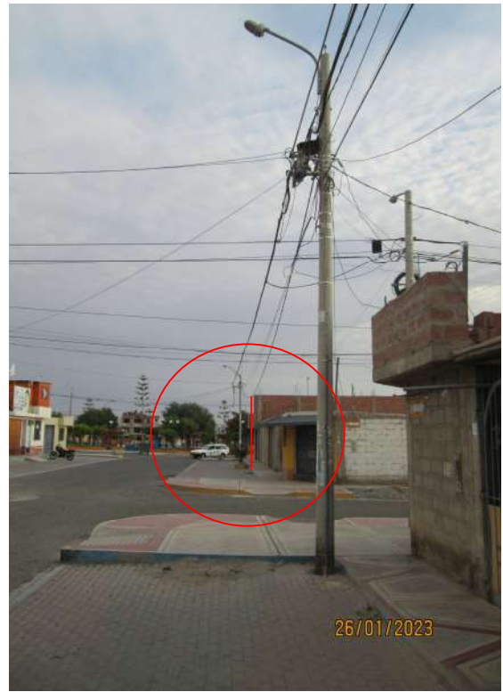
FIGURA A-10 LUGAR: Vano SED D-1447/3-14 a 3-08 OBSERVACIONES: Conductor incumple DMS vertical con respecto al suelo
