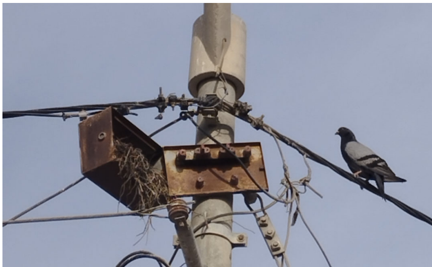
Figura 14. Caja de derivación que muestra todas las deficiencias.
