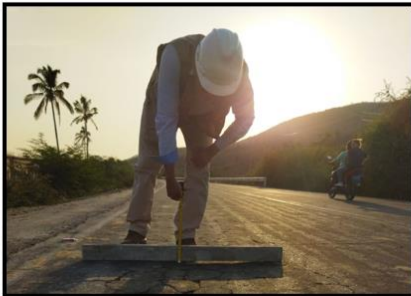
Foto N° 05. Toma fotográfica de la falla Tipo Abultamiento y Hundimiento en el pavimento en estudio.
