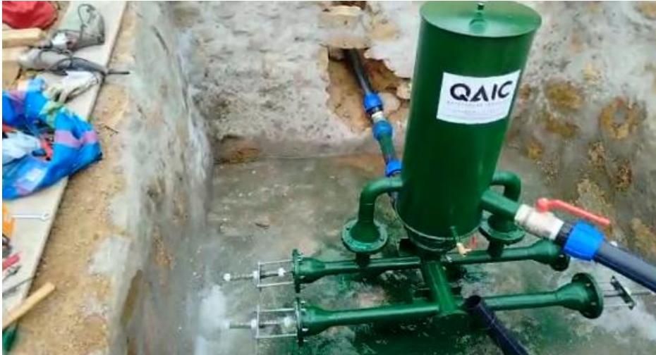
Figura 6: Ubicación de bomba de ariete a utilizar.
