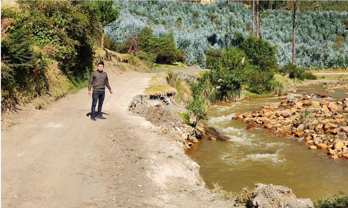
Fotografía 9: Se observa que el río está llevando parte de la plataforma de la carretera ocasionando peligro la circulación de los vehículos.
