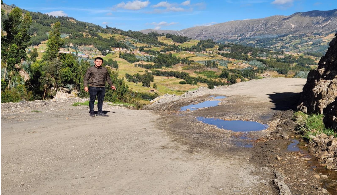
Fotografía 19: se observa que el agua cruza la vía, al no contar con una alcantarilla, en este punto se diseñara la primera alcantarilla.
