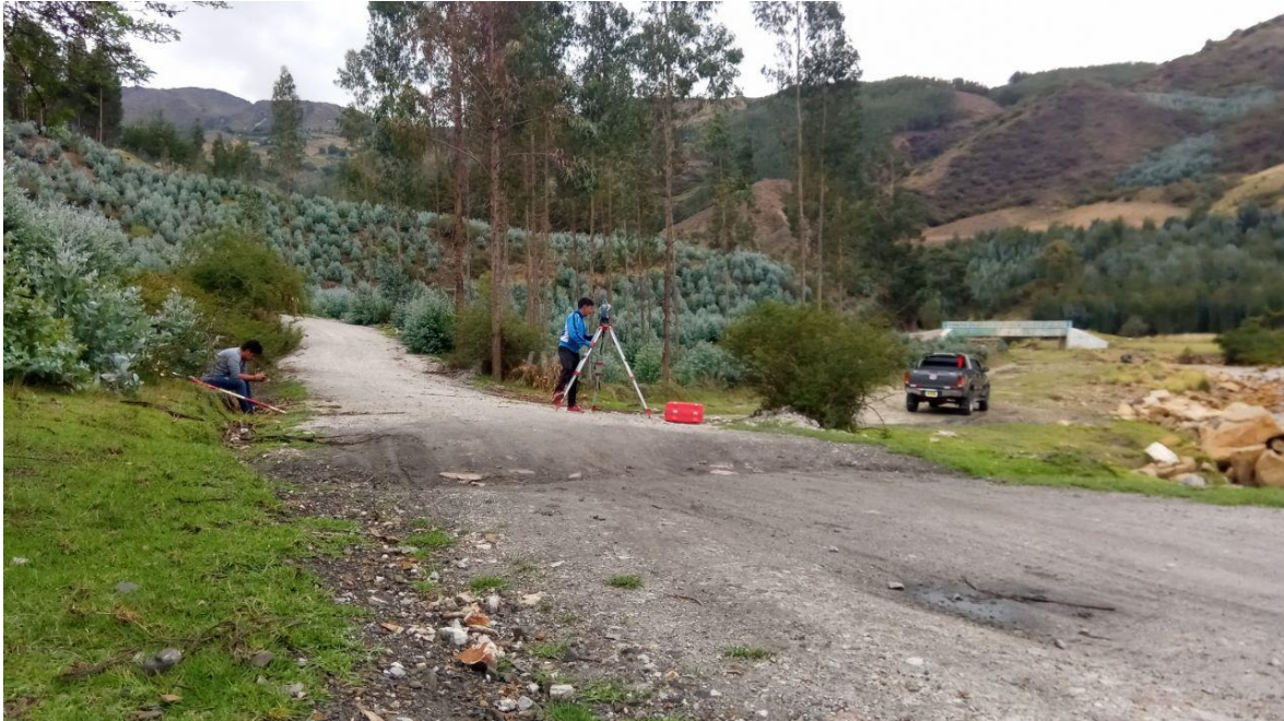
Fotografía 1: realizando el levantamiento de la topografía con la estación total, dichos trabajos se realizaron durante 4 días.
