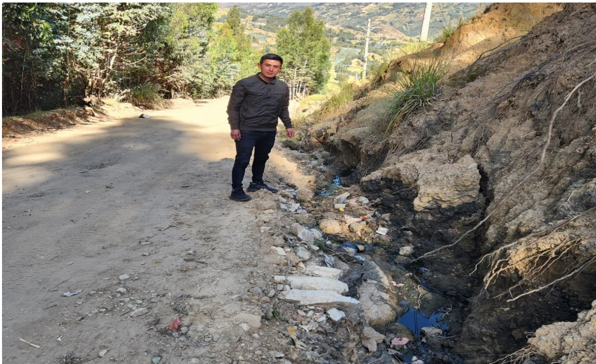
Fotografía 4: Se observa en la imagen una cuneta totalmente deficiente, la cual está llevando un poco de la superficie de rodadura.
