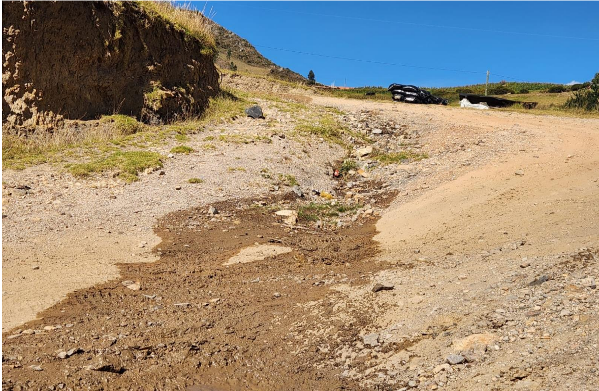
Fotografía 11: Se aprecia el ahuellamiento provocado por el escurrimiento del agua producto de que no hay cunetas, así mismo se aprecia pendientes muy pronunciadas.
