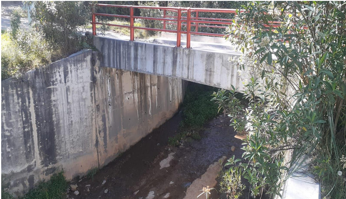
Fotografía 6: Como se aprecia el estado del puente está en buenas condiciones, en la imagen se aprecia la condición de los estribos corroborando la condición de servicio en óptimas condiciones.
