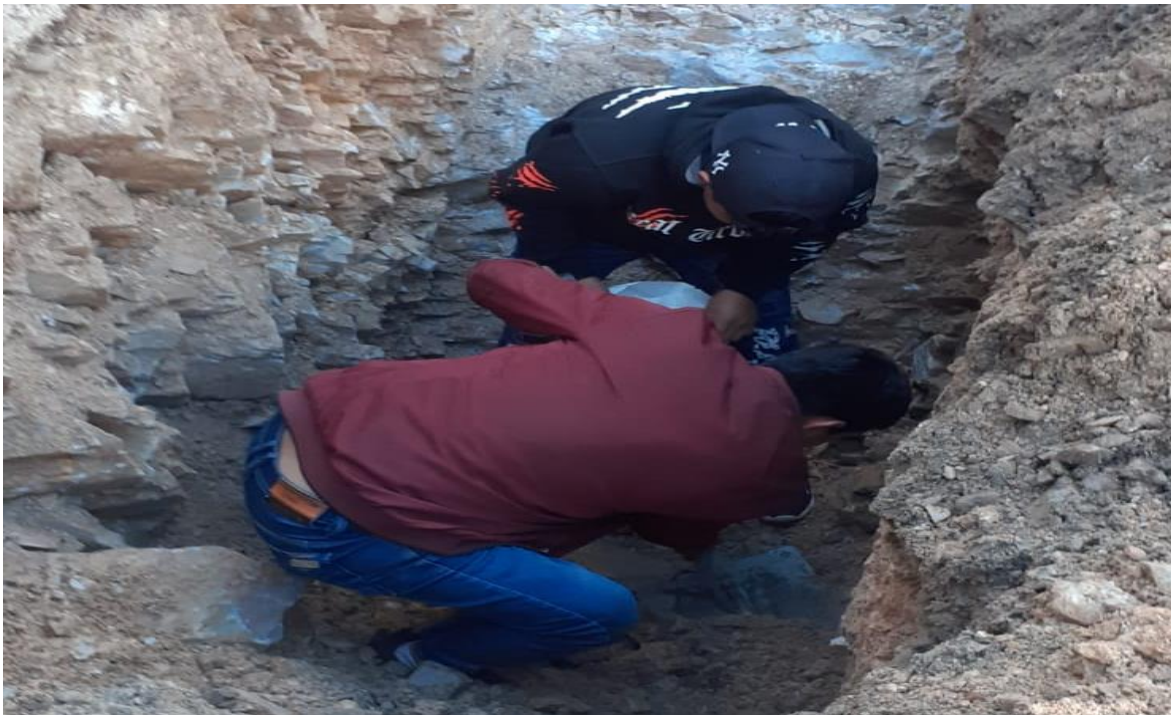
Fotografía 24: se aprecia la extracción de la muestra de la calicata 1, la cual fue extraída a una profundidad de 1.55m aproximadamente
