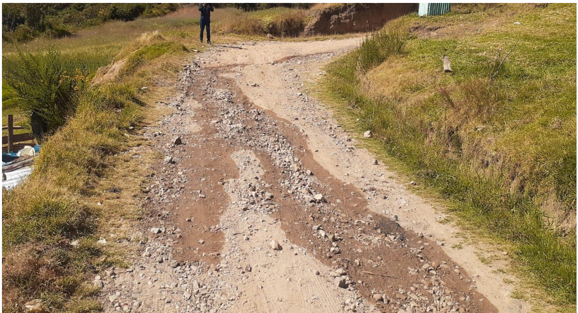
Fotografía 12: Ahuellamientos presentes en la vía, se observa además un área mojada ya que el agua está siguiendo su curso en la vía por falta de cunetas.
