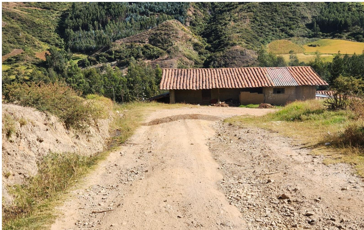
Fotografía 16: Mismo estado de la foto anterior, una vía sin cunetas y con una pendiente pronunciada.
