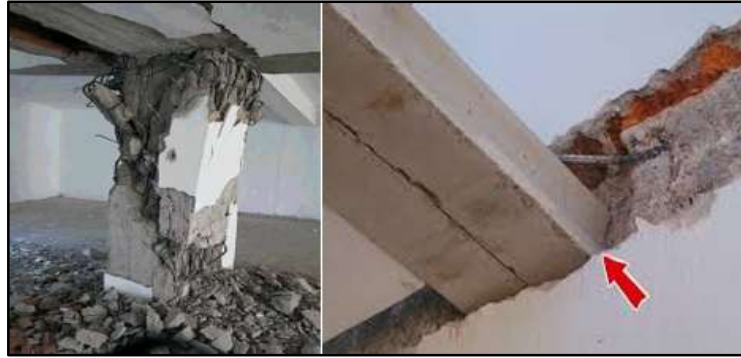
Figura 2. Fallas estructurales por mal manejo constructivo Fuente: https://bit.ly/3l57Ufj
