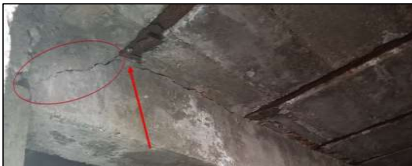
Figura 1. Agrietamientos en vigas
