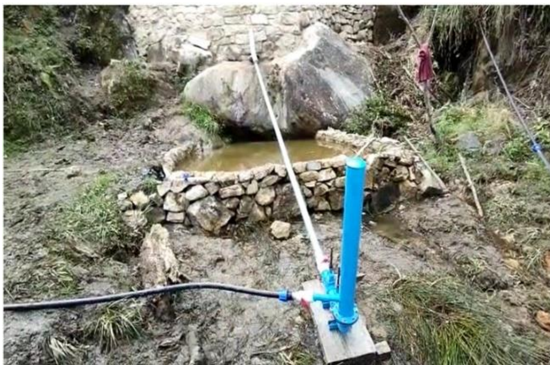
Figura 7. Vista de la bomba de Ariete
