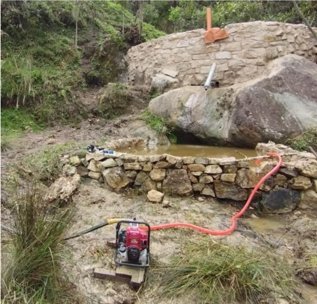
Figura 8. vista de la motobomba
