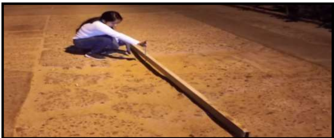
Pavimento Dañado: - Desprendimiento de Agregados.
