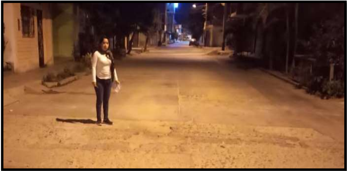
Estado Actual del Pavimento.
