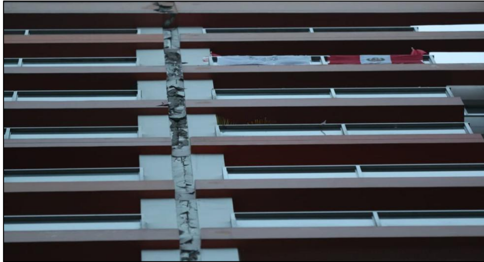
Figura 1. Daños en un edificio ubicado en Jesús María tras fuerte temblor
