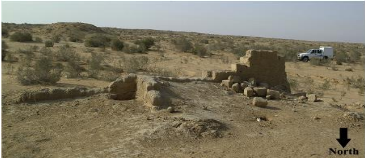
Figura 1. Degradación de una edificación de adobe en Israel
