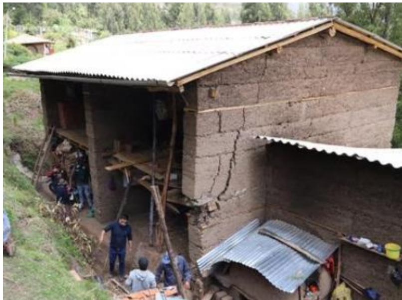
Figura .: Grietas en el muro de adobe Fuente: https://n9.cl/1ud52
