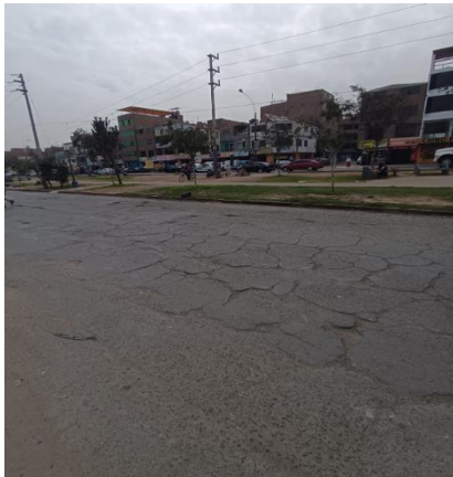
Imagen 15. Huecos en el pavimento flexible
