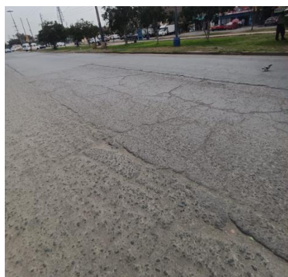
Imagen 21. Falla de grietas en bloque, piel de cocodrilo
