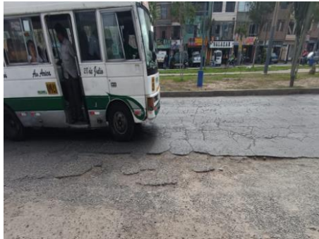
Imagen 39. Tránsito vehicular en fallas de huecos y piel de cocodrilo
