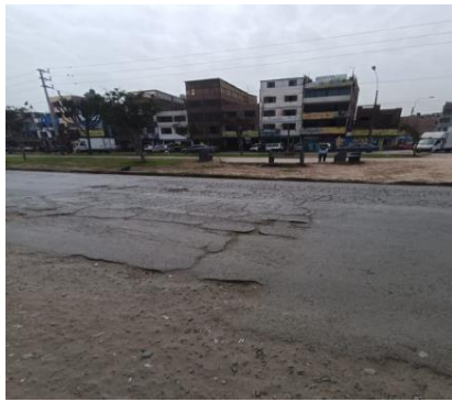
Imagen 33. Desgaste de pavimento
