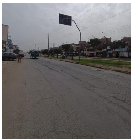
Imagen 23. Falla de piel de cocodrilo
