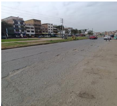
Imagen 29. Presencia de huecos, grietas longitudinales
