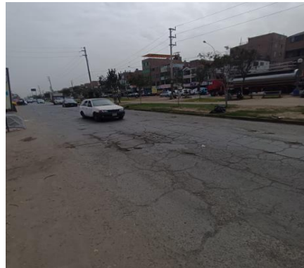
Imagen 32. Presencia de huecos y grietas en pavimento durante tránsito vehicular
