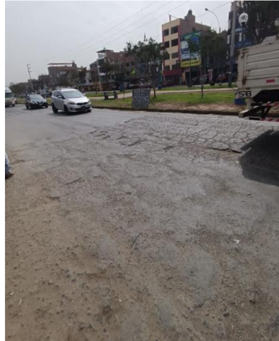
Figura 22 y 23. Fallas encontradas en campo
