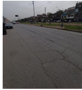
Imagen 26. Falla de piel de cocodrilo y brietas en bloques
