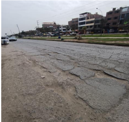
Imagen 31. Presencia de grietas en bloques, huecos, desprendimiento
