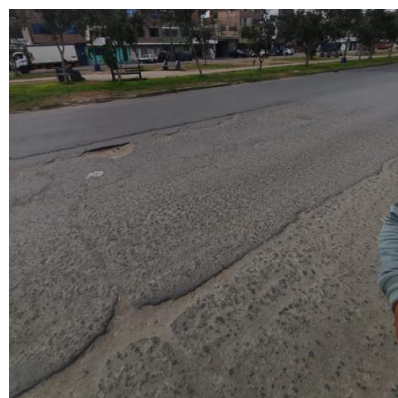
Imagen 22. Parches, desprendimiento y huecos
