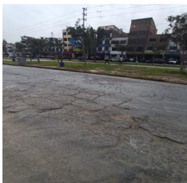
Imagen 35.. Ahuellamiento, desprendimiento, grietas en bloque
