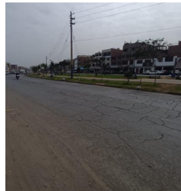
Imagen 36. Tramo de pavimento en encondición regular
