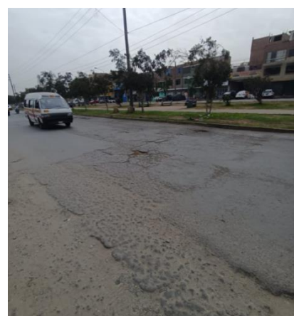
Imagen 18. Parches, desprendimiento y huecos
