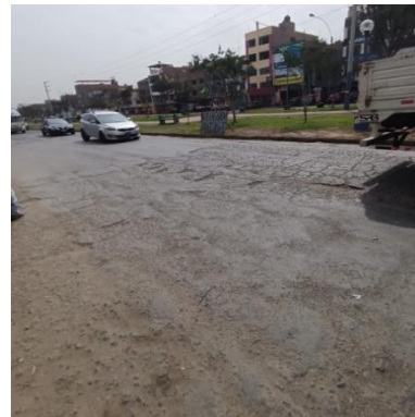
Imagen 34. Tramo de pavimento en encondición severa
