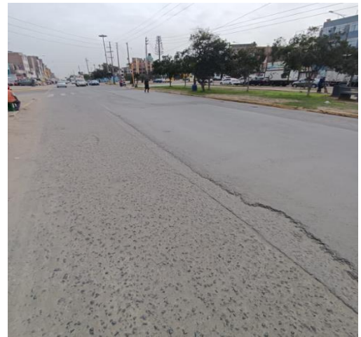
Figura 33. Grieta de borde
