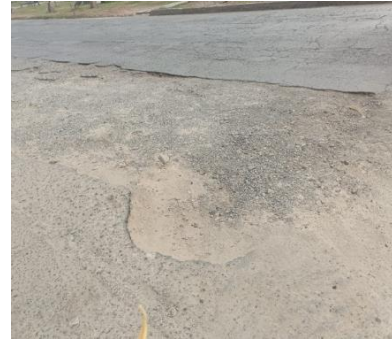
Imagen 40. Falla en el pavimento próximo a ser una falla estructural
