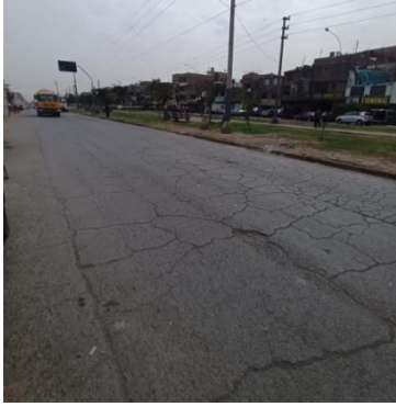
Imagen 25. Falla de piel de cocodrilo
