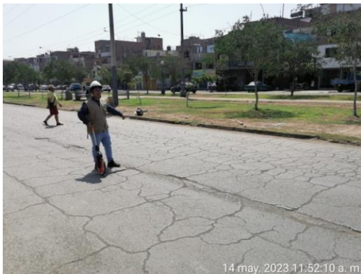
Figura 3: Ident. de fallas superficiales.
