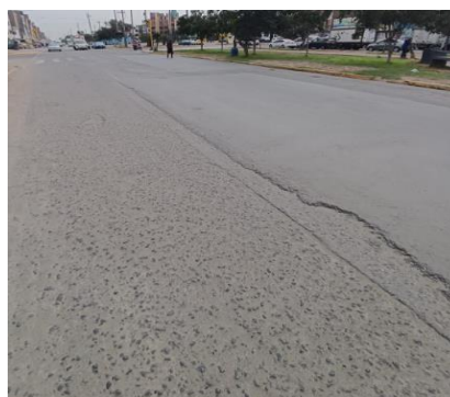
Imagen 20. Grietas en bloque y grieta de borde
