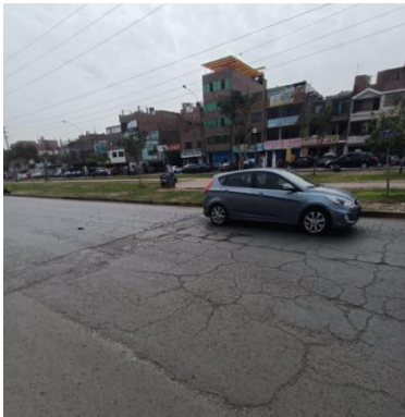
Imagen 27. Tránsito vehicular en pavimento flexible con piel de cocodrilo
