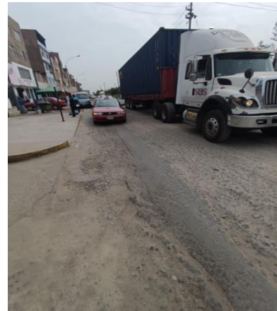
Imagen 16. Desprendimiento y corrugación
