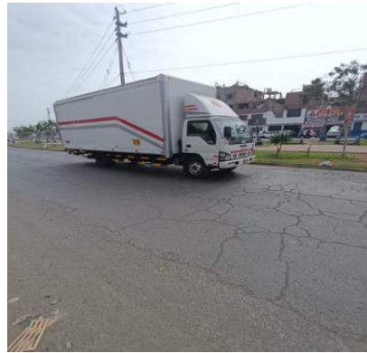
Imagen 14. Falla grieta en bloques
