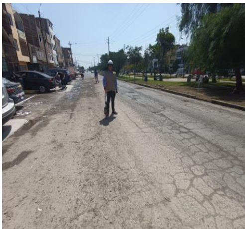
Figura 5: Ident. de fallas superficiales
