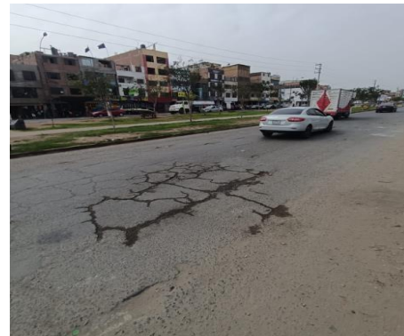
Imagen 30. Falla de piel de cocodrilo
