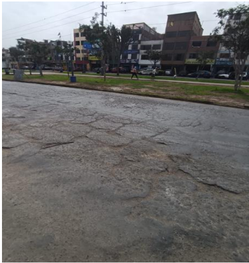
Figura 32. Huecos y grietas en bloque
