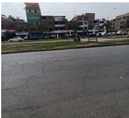
Imagen 19. Falla de piel de cocodrilo
