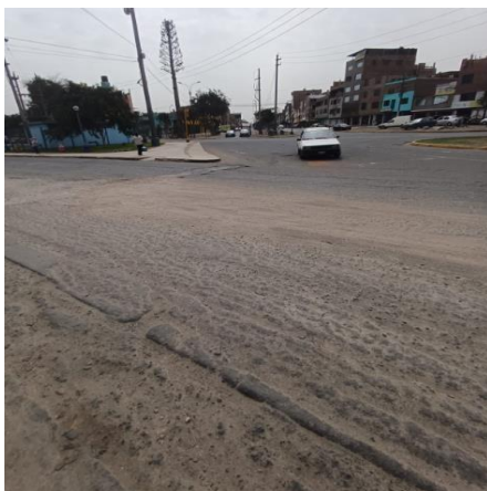
Imagen 17. Desprendimiento y corrugación
